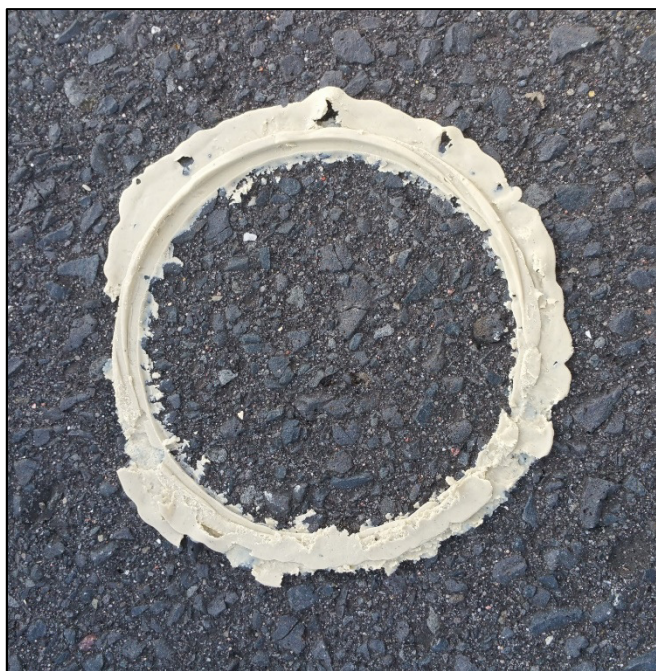
Fot. 2.11. Widok pozostałości uszczelniacza po wykonaniu pomiarów i zdemontowaniu łącznika „in situ”
