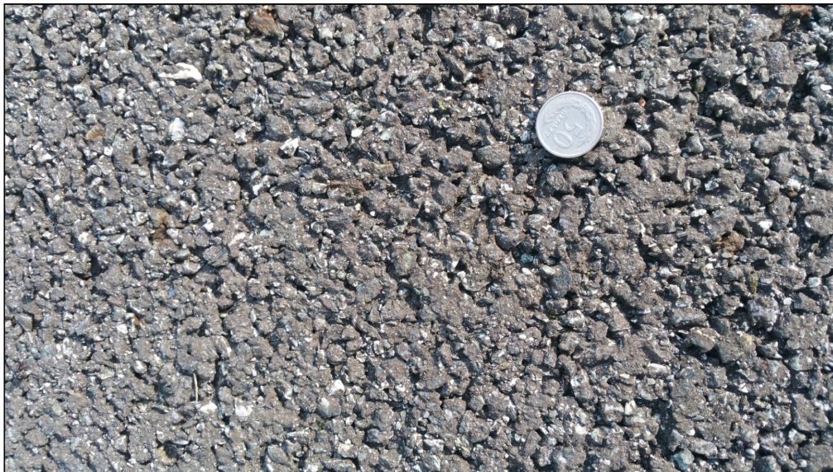
Fot. 3.6. Widok badanej nawierzchni drogowej wykonanej z mieszanki mastyksowo – grysowej SMA 8
