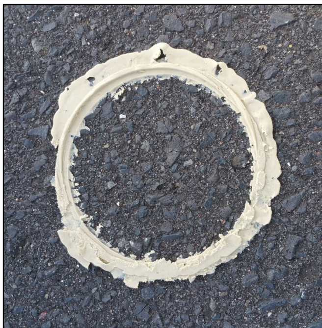
Fot. 2.14. Widok pozostałości uszczelnacza po wykonaniu pomiarów i zdemontowaniu łącznika „in situ”
