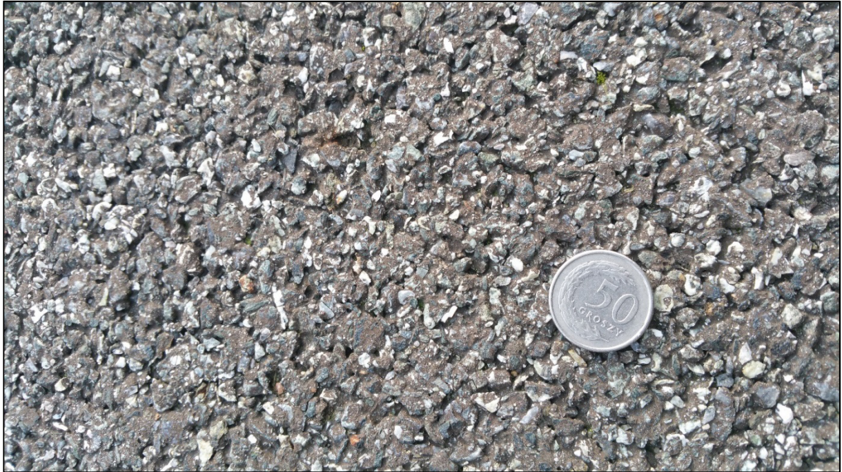
Fot. 3.8. Widok badanej nawierzchni drogowej wykonanej z mieszanki mastyksowo – grysowej SMA 5
