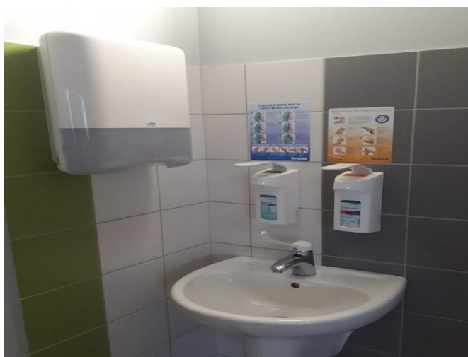
Stanowisko higieny rąk w ambulatorium na terenie miasta Katowice (Źródło: Zdjęcie własne)
