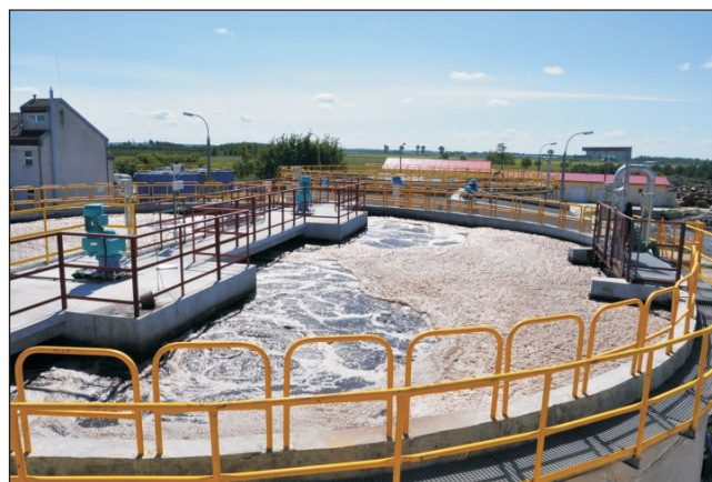
Ryc. 38. Oczyszczalnia ścieków w Pisz – komora nityfikacji (fot. Archiwum WFOŚiGW w Olsztynie)
