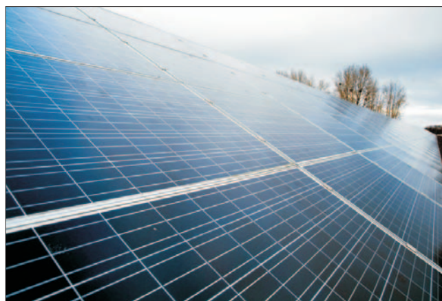
Ryc. 40. Instalacja fotowoltaiczna (fot. Archiwum WFOŚiGW w Olsztynie)
