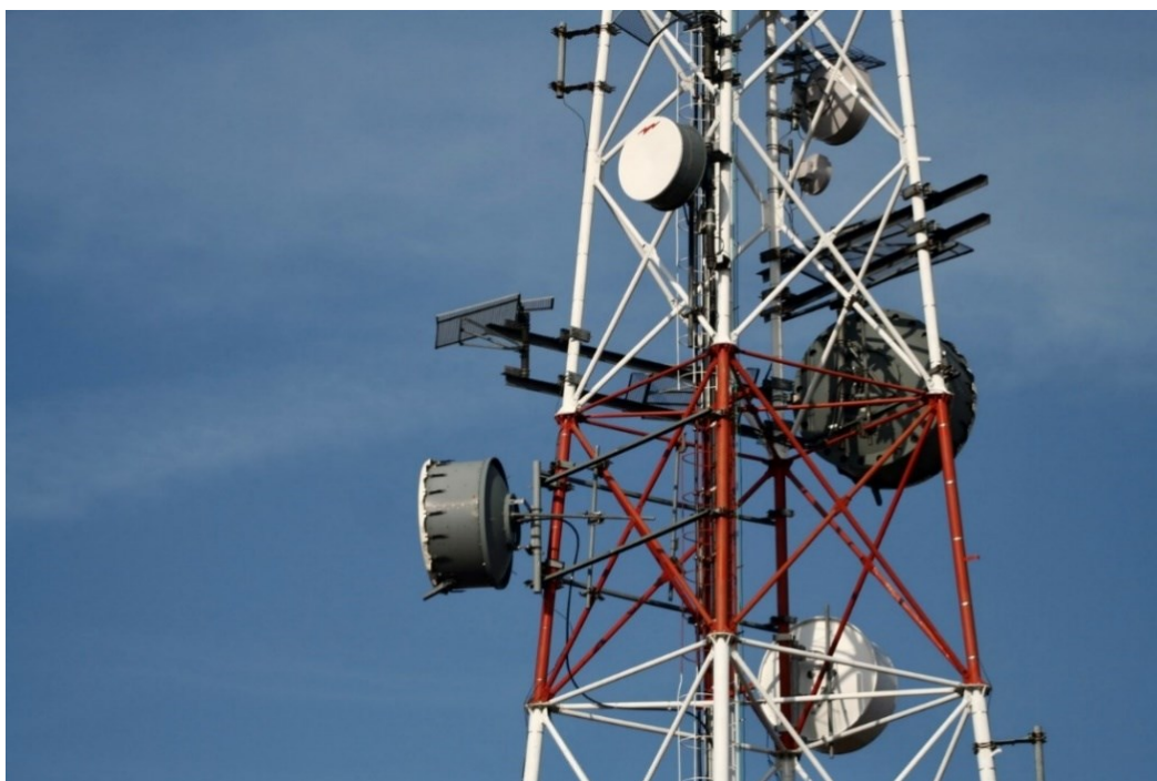
Rys. Wieża kratowa z zainstalowanymi systemami antenowymi (zdjęcie własne)
