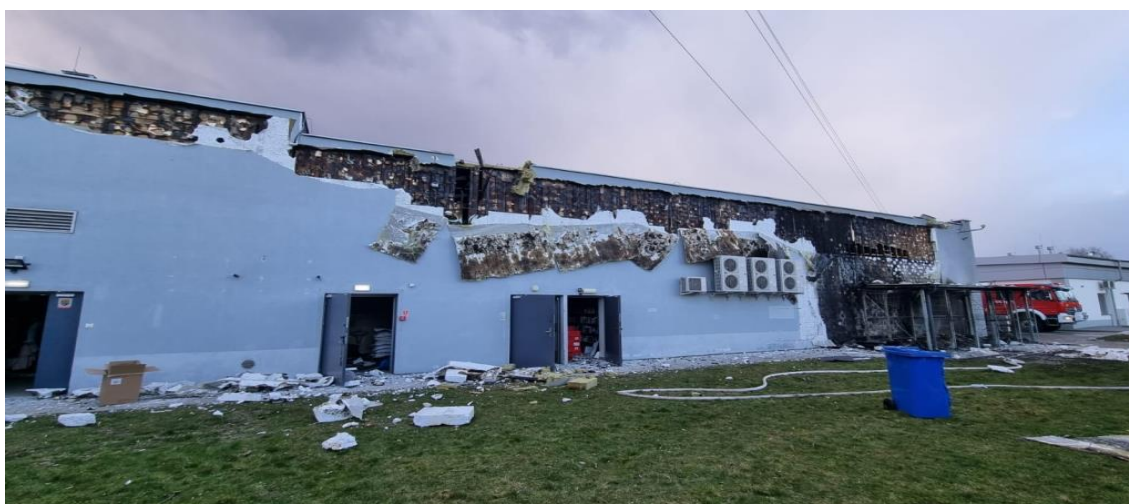
Pożaru budynku handlowo – usługowego w Rumii
