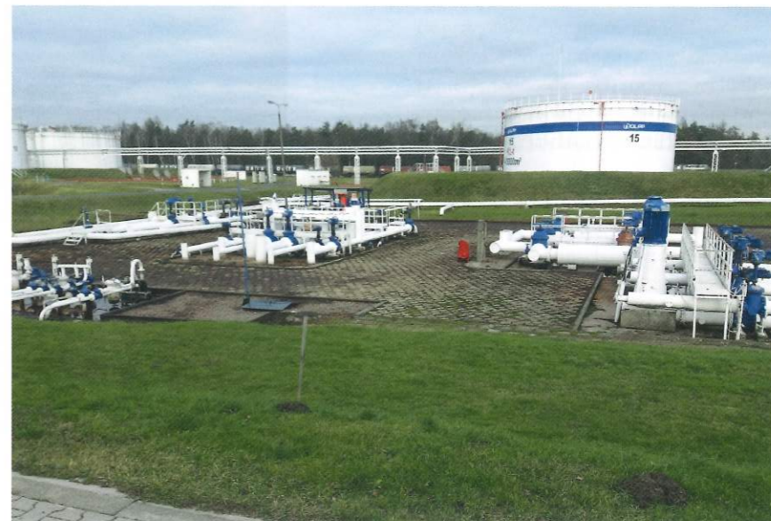
Urządzenia stacji przyjęcia paliw z rurociągu dalekosiężnego źródło: PERN SA
