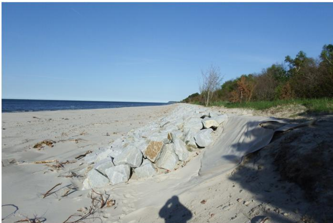
Fot. 26. Warstwa grubego kamienia na geowłókninie zamiast gabionów chroniąca wydmy; widoczny początek rozwoju naturalnej wegetacji na koronie wydmy, rejon Karwia – Piaśnica
