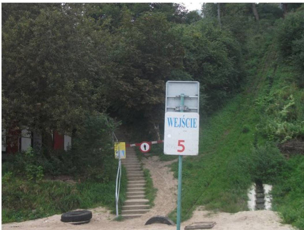
Fot. 22. Oksywie. Nieczynne wejście i wylot rynny (wrzesień 2016 r.)
