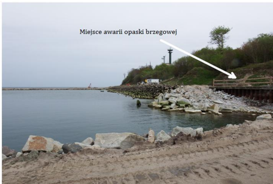
Fot. 35. Miejsce awarii starej opaski brzegowej: poślizg całego zbocza klifu razem z opaską brzegową
