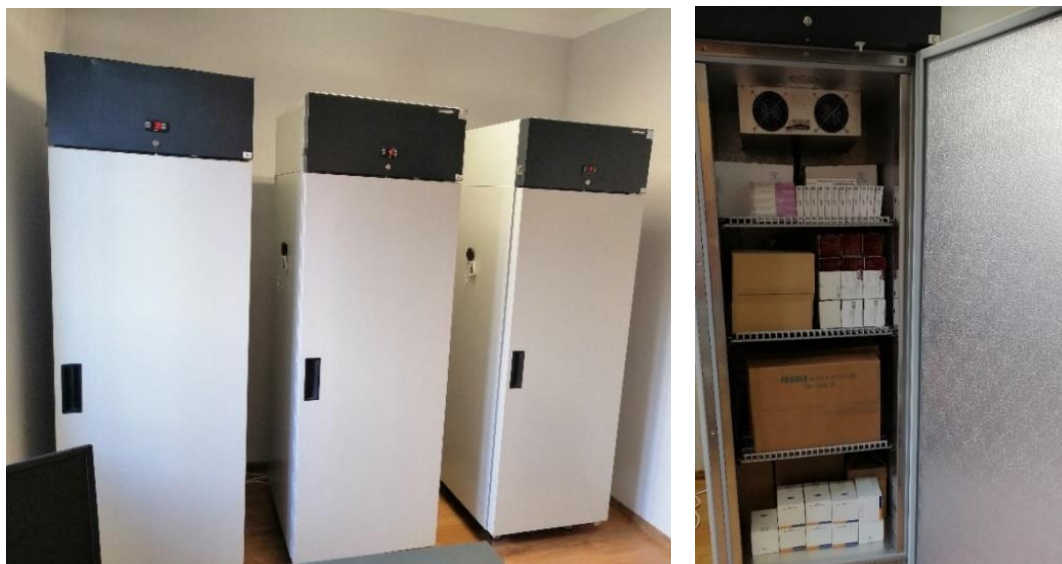
Zdj. Urządzenia chłodnicze, w których przechowywane są preparaty szczepionkowe w magazynie Powiatowej Stacji Sanitarno-Epidemiologicznej w Rzeszowie
