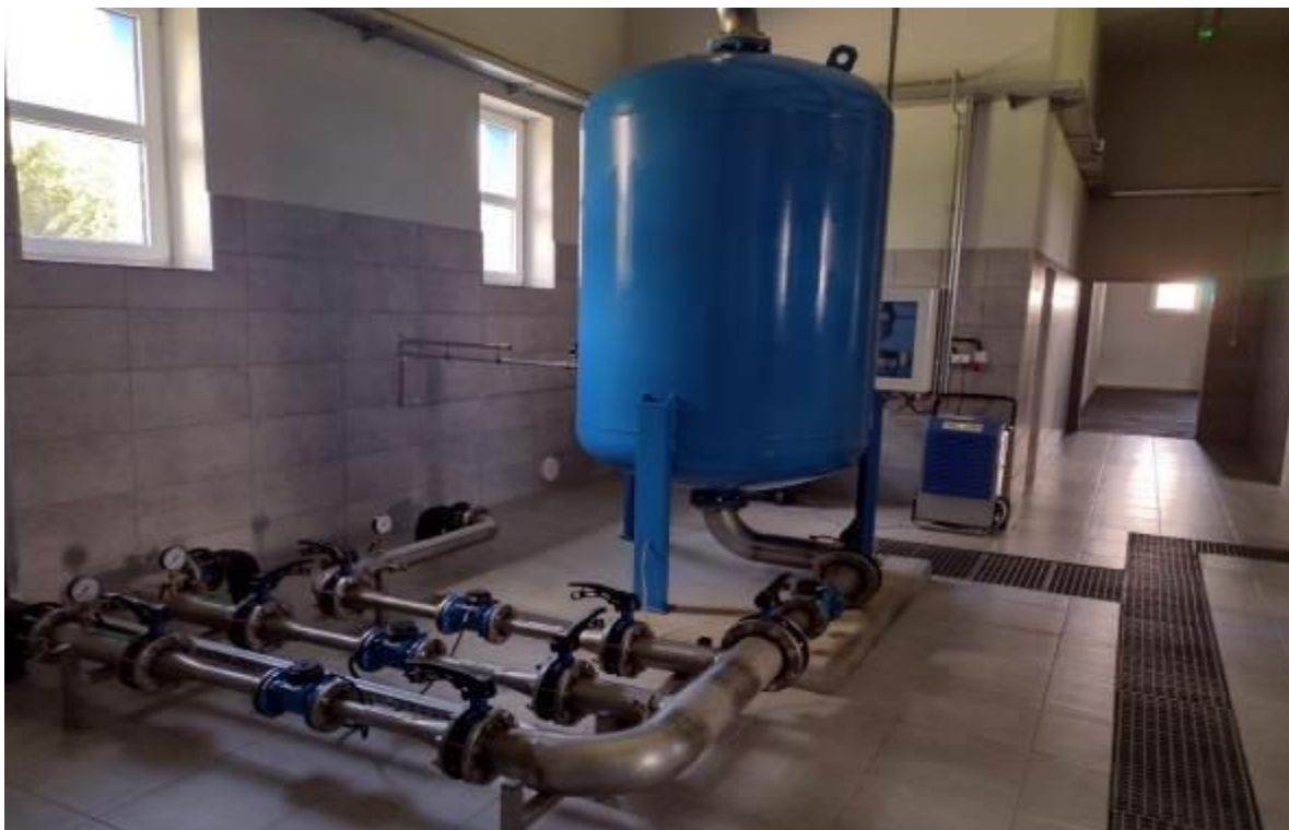
Aerator powietrza w hydroforni w Potulinie Fot. Alina Borlikowska
