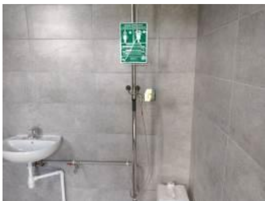
Myjka do oczu w pomieszczeniu chlorowni wodociągu publicznego w Potulinie Fot. Alina Borlikowska
