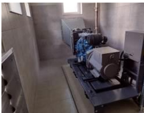
Agregat prądowoczą Fot. Alina Borlikowska
