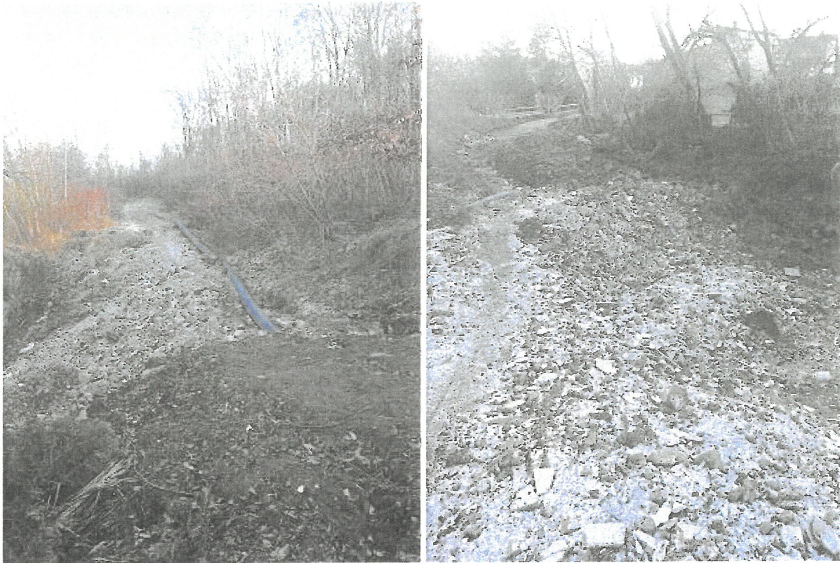
Rys. 13 Stan drogi w Lednicy Górnej w rejonie ul. Solarskiego i rzeki Miodówki
