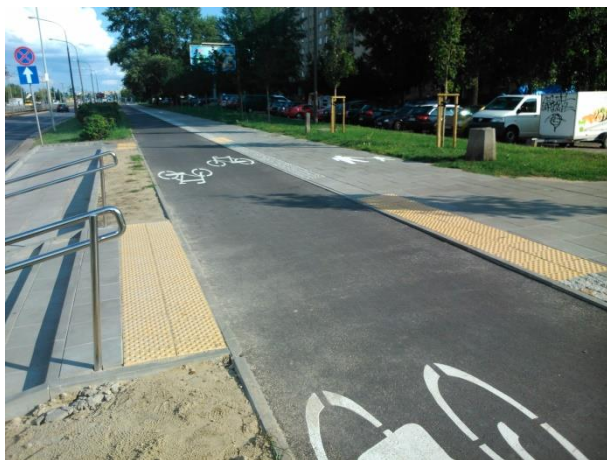
Fot. 6.33. Infrastruktura dla niepełnosprawnych – struktura nawierzchni przed drogą dla rowerów tzw. pola uwagi
