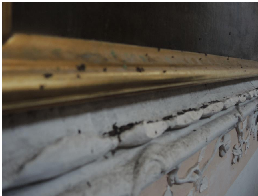
Odchody karlików na ścianach przy obrazach w kościele (fot. J. Furmankiewicz)
