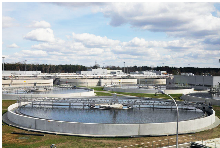
Oczyszczalnia ścieków Czapka w Warszawie
