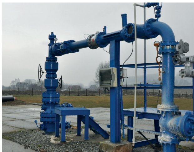
Fragment instalacji PEC Geotermia Podhalańska S.A. w Bańskiej. NFOŚiGW jest współwłaścicielem Spółki
