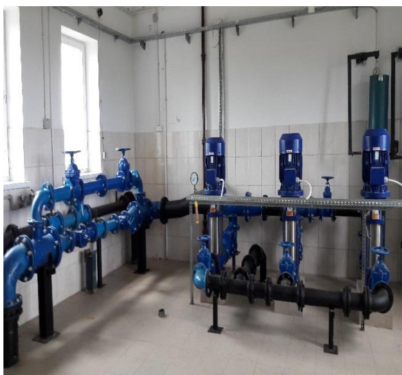
Zdjęcie 1. Przepompownia Wszechświęte
