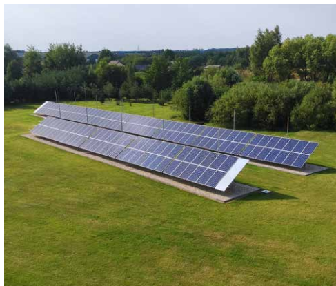
Mikroelektrownia PV na terenie OŚ w Kłobucku
