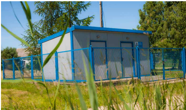
Jedna z wielu eksploatowanych przepompowni ścieków
