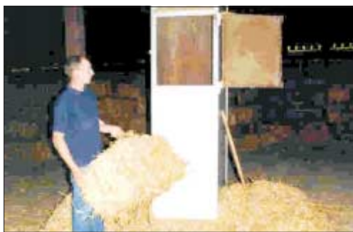
Przewód wentylacyjny chlewni wykorzystywany jako otwór zrzutowy słomy z poddasza użytkowego budynku - do pomieszczenia gdzie przebywają zwierzęta.
