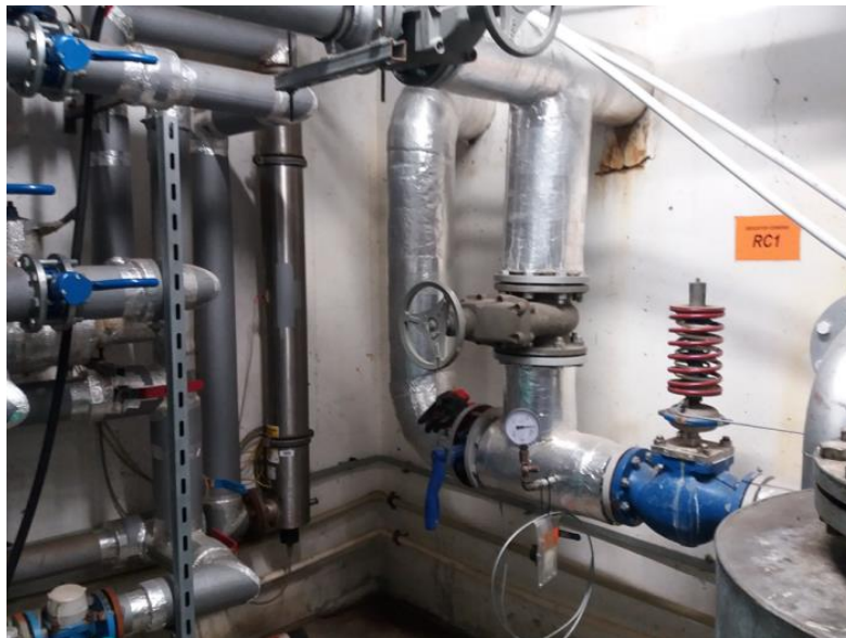
Fragment instalacji doprowadzającej wodę geotermalną z otw. Chochołów IG-1 do Chochołowskich Term (fot. B. Kępińska)
