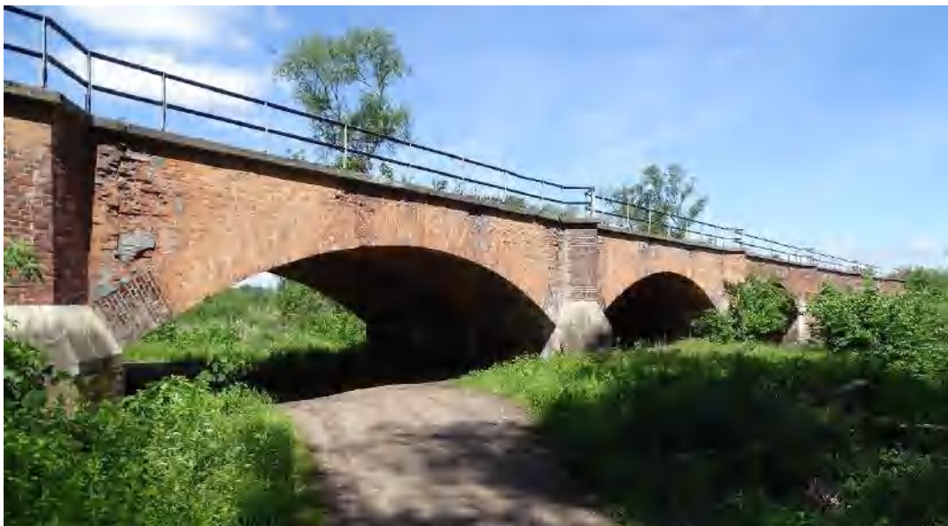
Fot. 1 Widok na fragment mostu nad Suchodołem w km 341,872 linii kolejowej nr 203
