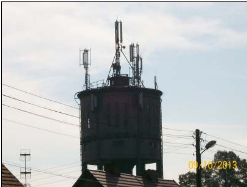
Fot. 3. Fragment instalacji radiokomunikacyjnych na wieży wodnej
