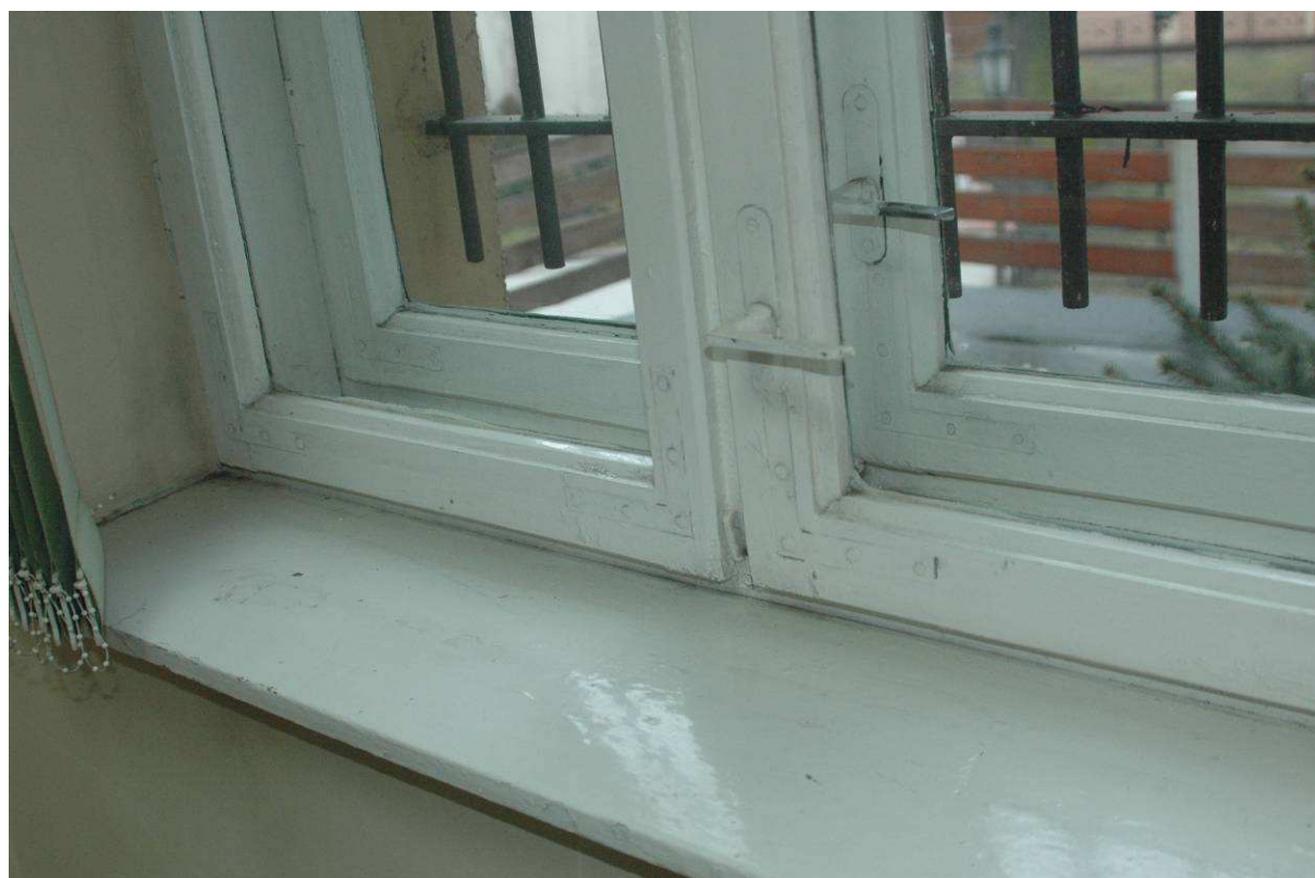
fot. 2. Stan techniczny okien przeznaczonych do wymiany.
