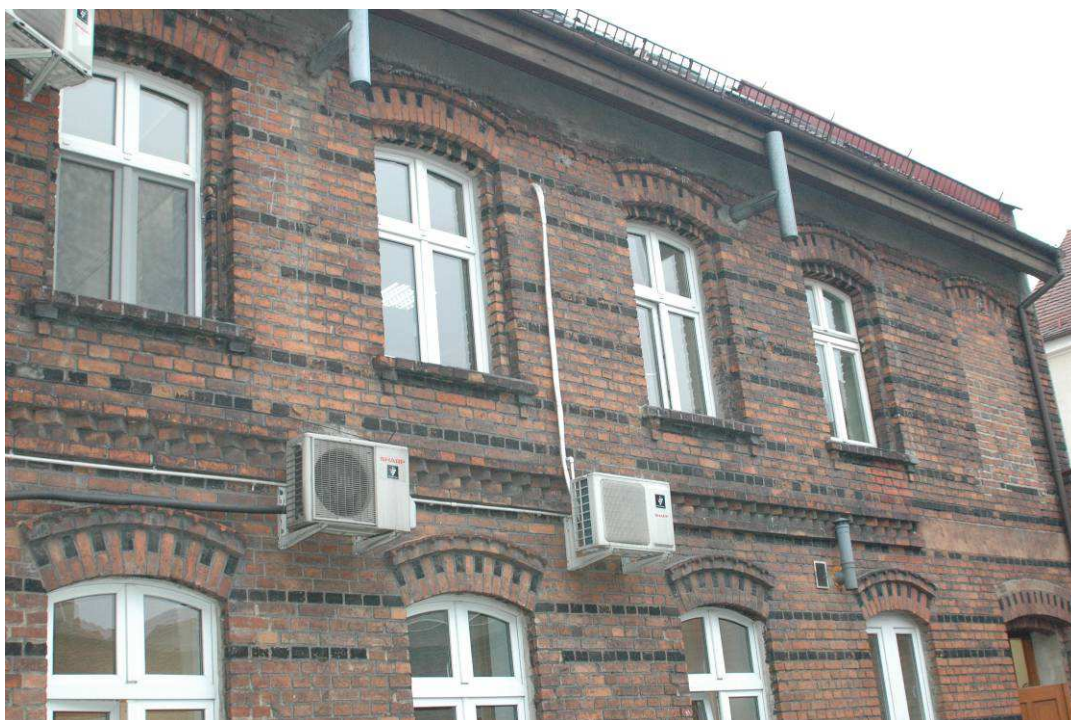
fot. 1. Stan techniczny elewacji.
