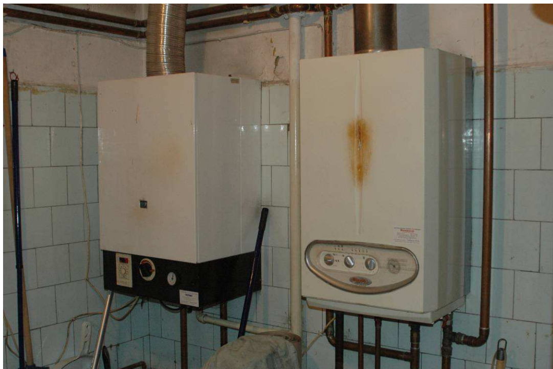
fot. 3. Kotłownia gazowa
