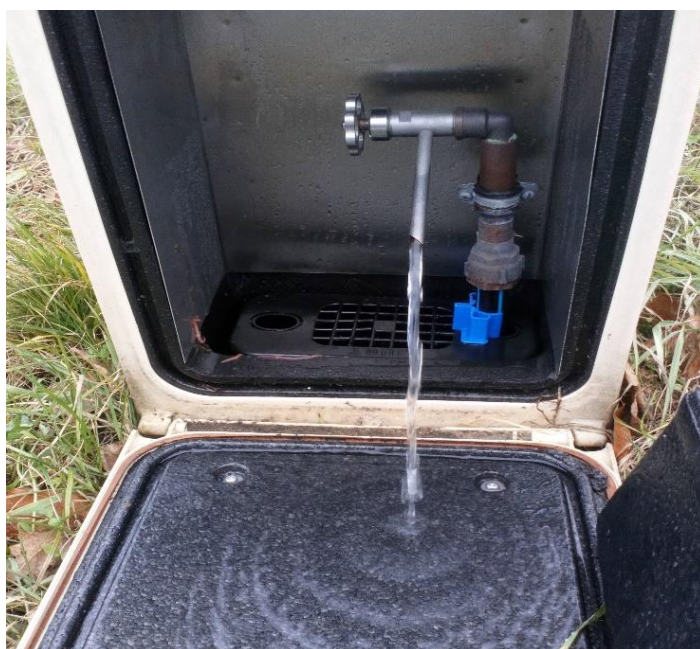
Zdjęcie: Punkt monitoringowy na sieci wodociągowej - „skrzynka do pobierania próbek wody”.
