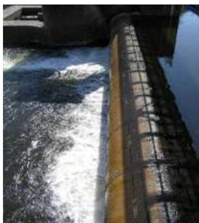
Walec będący zamknięciem jazu
