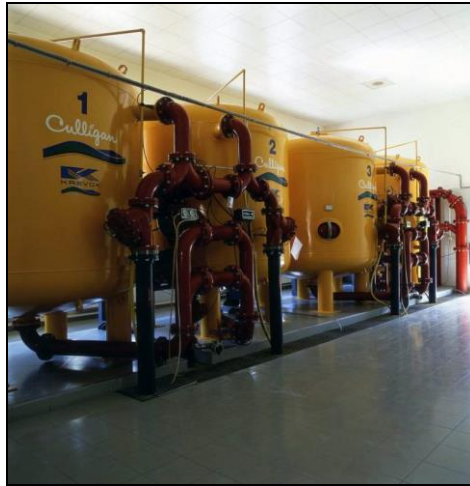
Stacja uzdatniania wody „Centralna”
