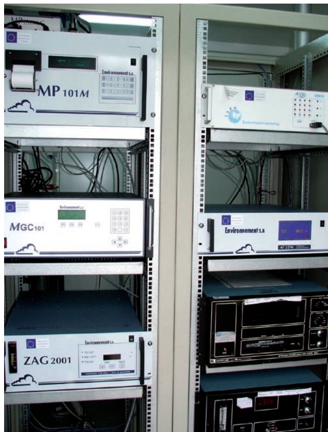
Fot. 9. Urządzenia zainstalowane na stacji w Cieszynie
