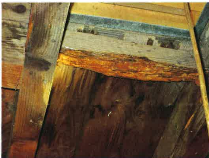
Liczne uszkodzenia konstrukcji drewnianej , rozkład drewna - konstrukcja wieży kościoła
