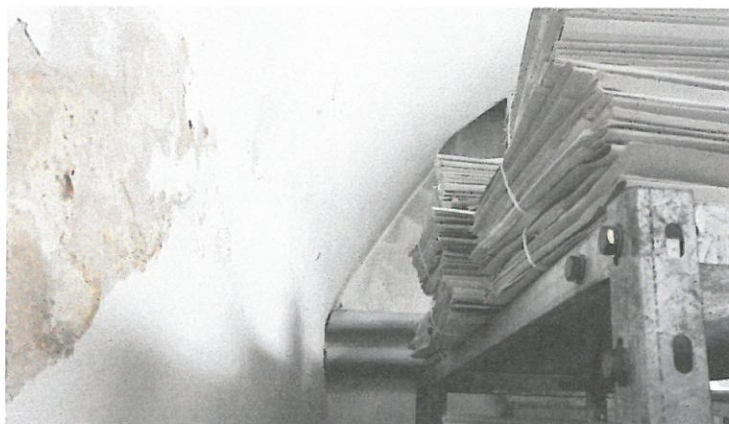
zawilgocona ściana w piwnicy
