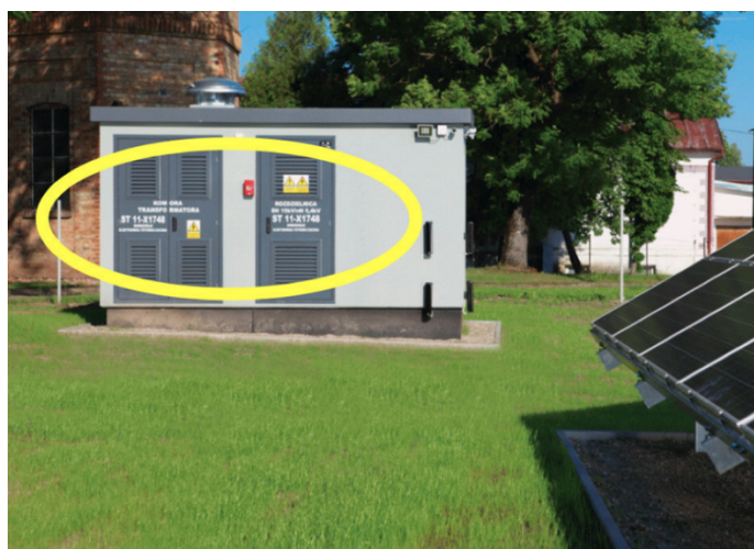
Rys. 15. Widok kontenerowej stacji transformatorowej. Źródło: opracowanie własne.
