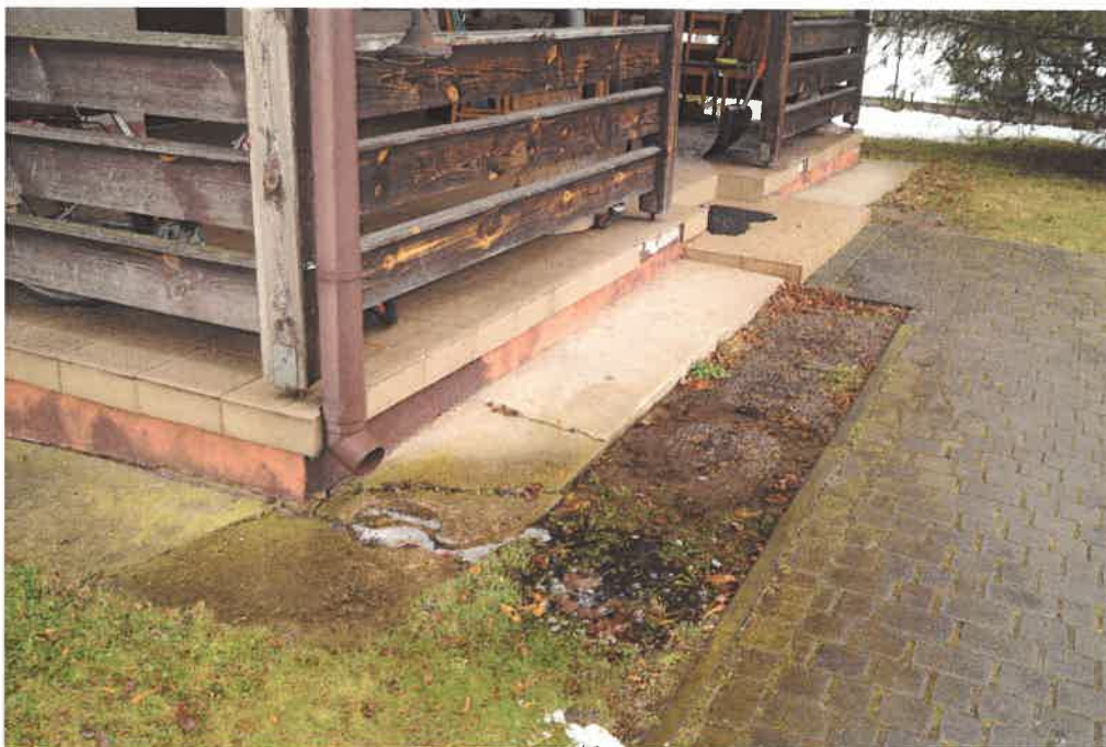
Cokół budynku – widoczne braki płytek tarasu
