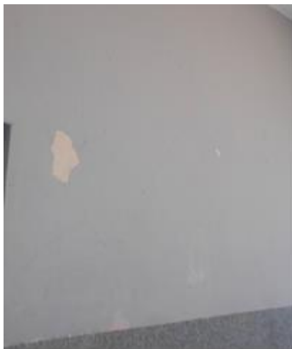
Rys. 28 Nieodpowiedni stan techniczny ciągów komunikacyjnych.
