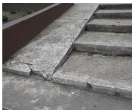
Rys. 31 Nieodpowiedni stan techniczny podjazdu dla osób niepełnosprawnych.
