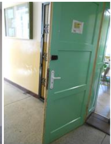
Rys. 29 Nieodpowiedni stan techniczny stolarki drzwiowej.
