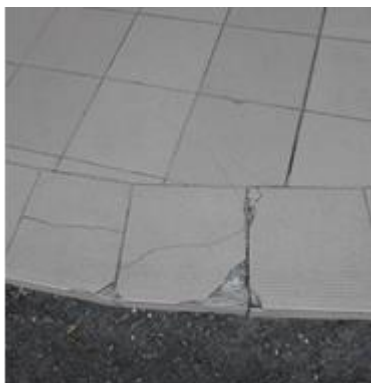
Rys. 30 Nieodpowiedni stan techniczny schodów zewnętrznych.
