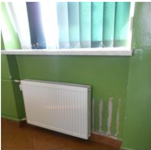
Rys. 27 Nieodpowiedni stan techniczny powierzchni ściany w sali lekcyjnej.
