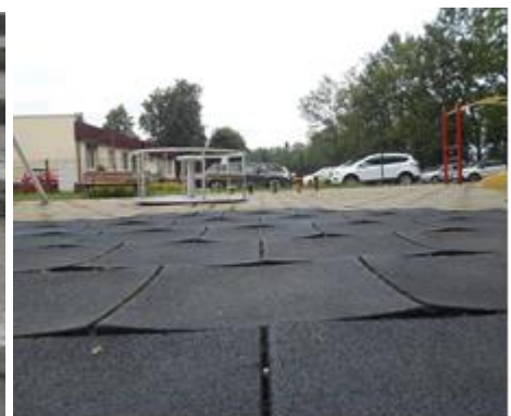
Rys. 32 Nieodpowiedni stan techniczny nawierzchni placu zabaw.
