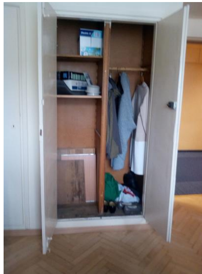
Zdj. Nr 1 Widok wnętrza szafy dwudrzwiowej
