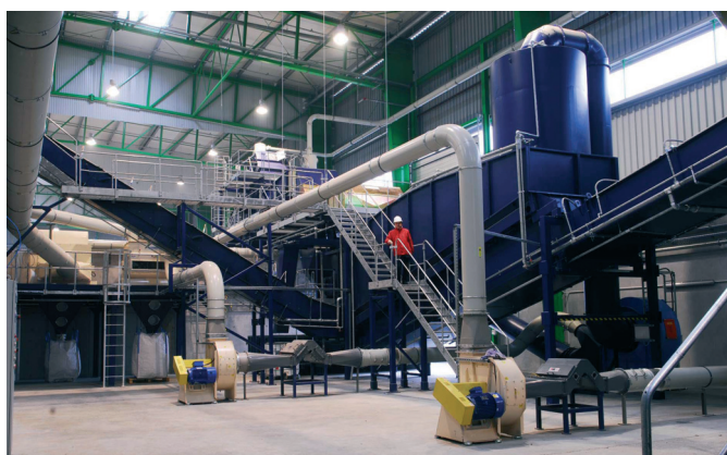
Fot. 1. Nowa instalacja w Zakładzie Produkcji Paliw Alternatywnych SITA Starol Sp. z o.o. w Chorzowie (zdjęcie z archiwum SITA Starol Sp. z o.o.)
