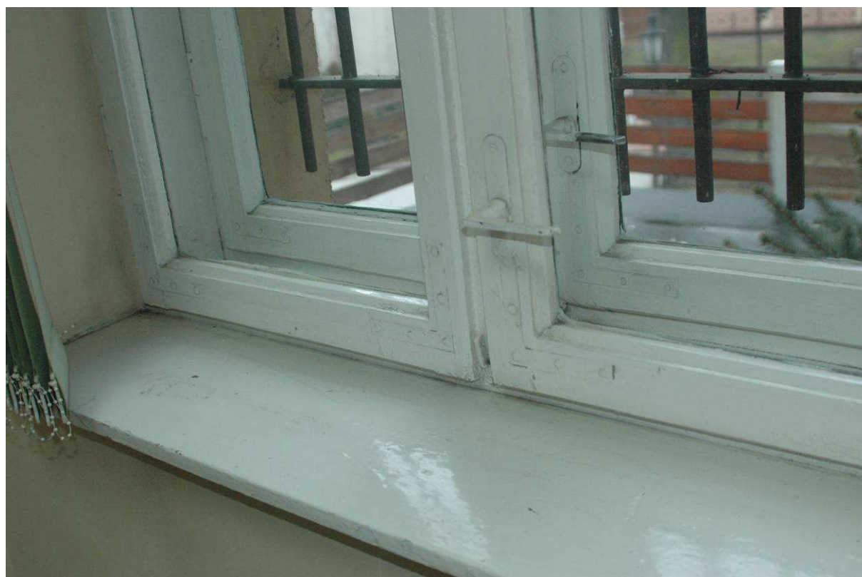
fot. 2. Stan techniczny okien przeznaczonych do wymiany.
