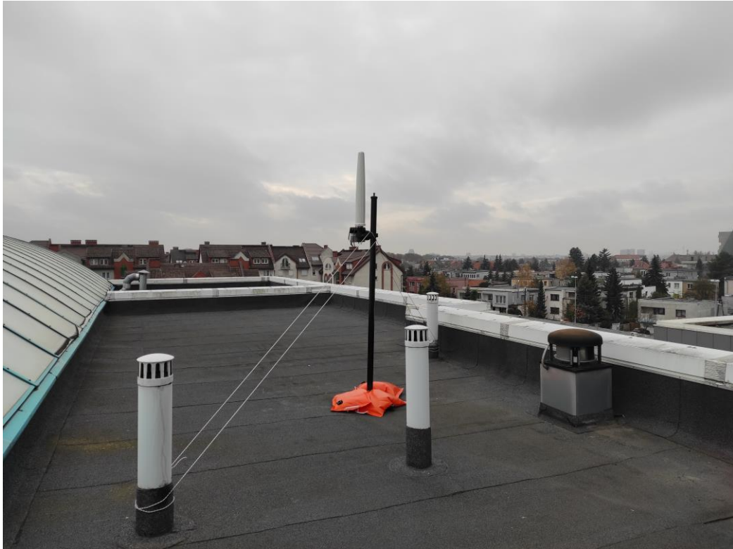
Rys. 3 Miejsce montażu pilotażowego SMS PEM – dach UM Poznań
