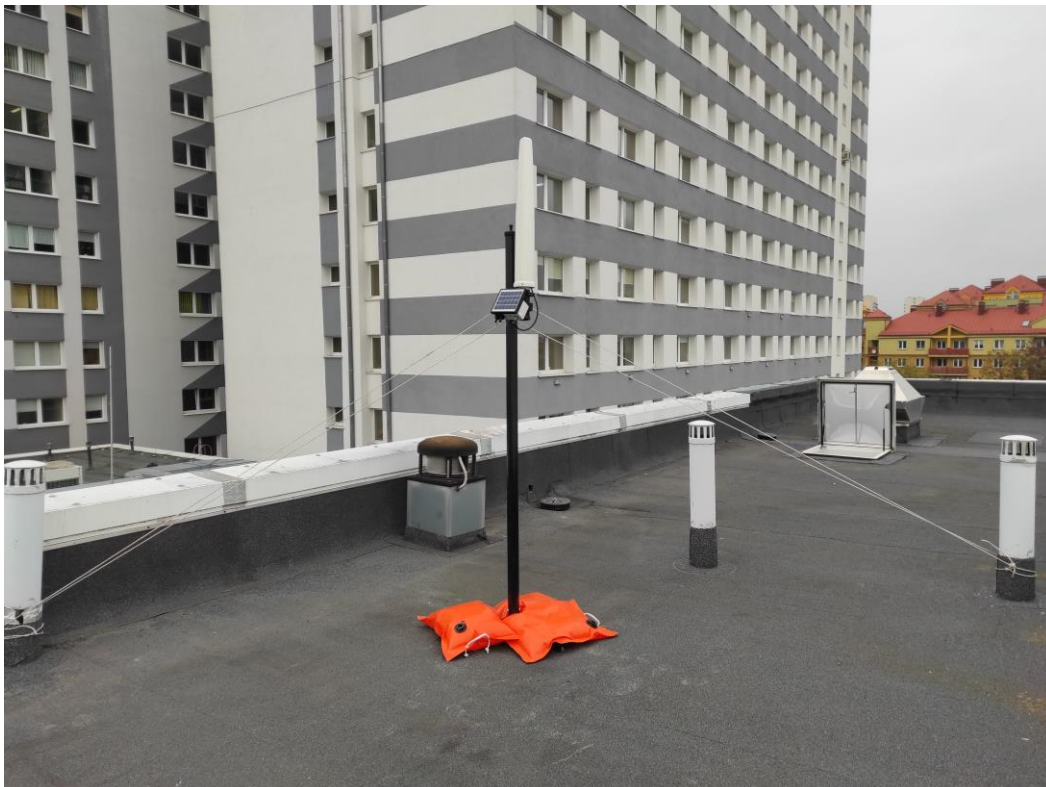
Rys. 4 Miejsce montażu pilotażowego SMS PEM – dach UM Poznań
