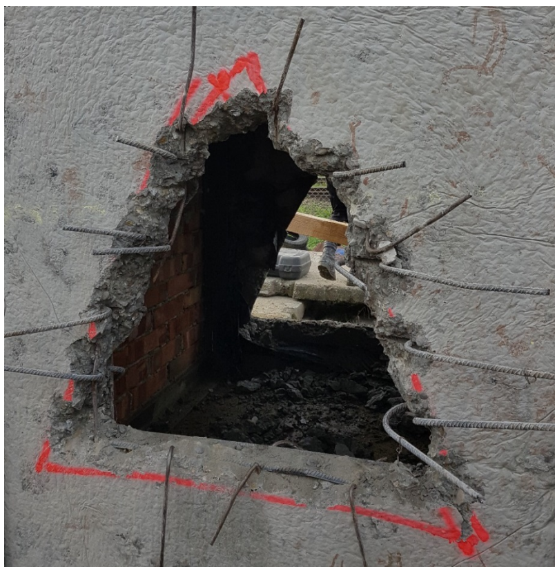
Fot. VI. 8. Przebicie w ścianie betonowej zbrojonej
