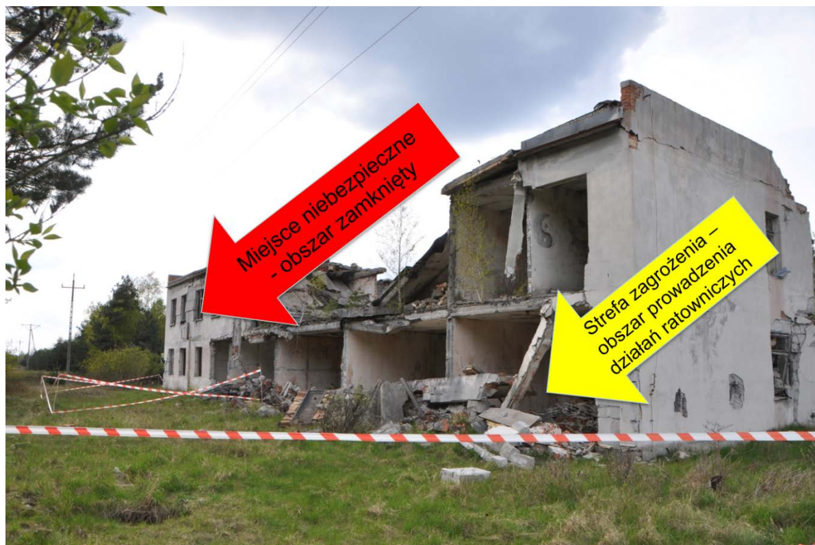
Fot. III. 6. Strefa zagrożenia i miejsce niebezpieczne
