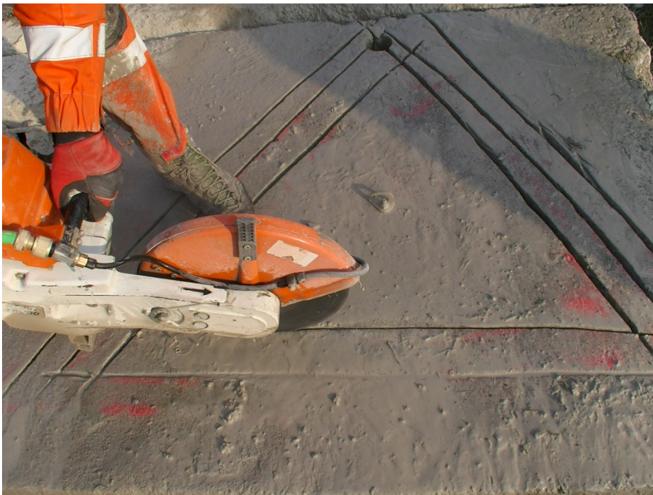
Fot. VI. 12. Wykonanie przebicia w stropie o dużej grubości – nacięcie na obwodzie (1)
