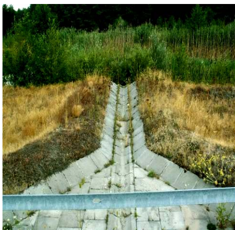
Fot. 2.7. Dopływ do stawu infiltracyjnego z roślinnością wodną - przykład dobrego rozwiązania, gdyby nie brak krat i osadnika przed zbiornikiem
