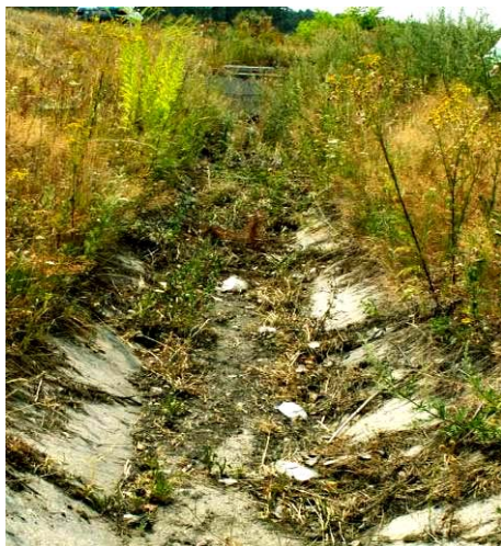
Fot. 2.1. Utrudniony dopływ wody rowem szczelnym do piaskownika i separator
