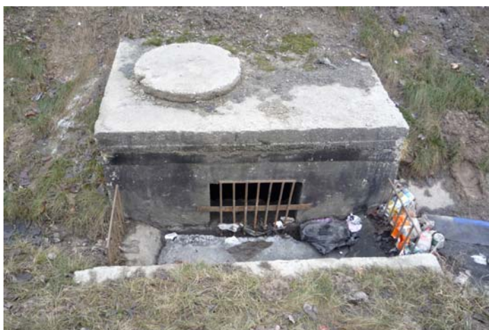
Fot. 1.1., 1.2. Odpady podobne do komunalnych trafiają z pasa drogowego do systemów odwodnień i utrudniają ich prawidłowe funkcjonowanie
