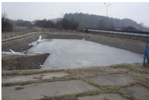
Fot. 2.18. Zbiornik retencyjno-sedymentacyjny współpracujący z pompownią – obwodnica Trójmiasta, węzeł Barniewice
