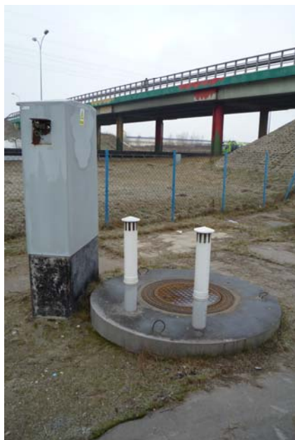
Fot. 2.23. Obwodnica Trójmiasta, węzeł Barniewice - pompownia zastosowana w układzie zbiorników retencyjnych i infiltracyjnych. Pompownia dozjuje ścieki do wyżej położonego zbiornika infiltracyjno-parującego.
