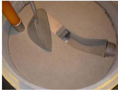
Fot. 2.22. Regulator wirowy zamontowany w studni z kinetą, odpływ z regulatora z dodatkowym króćcem pełniącym funkcję przelewu awaryjnego
