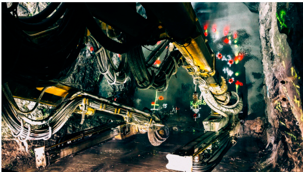
Fot.1. Wykopywanie pierwszego tunelu osadczego, który docelowo będzie miał długość nawet 350 m, rozpoczyna się w Onkalo (fot.: Posiva)
