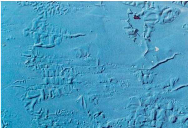
g) zmarszczenia, spękania głębokie
