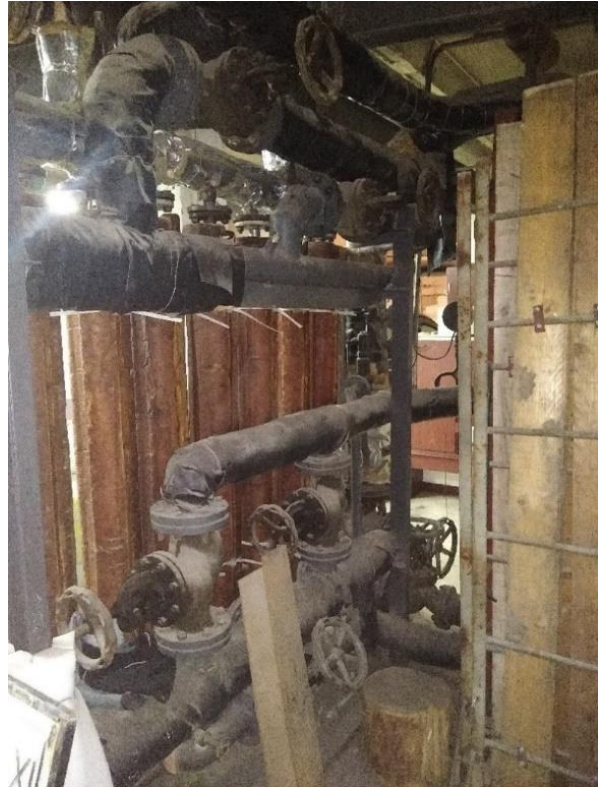
Rys. 214-6 | Bateria wymienników ciepła
