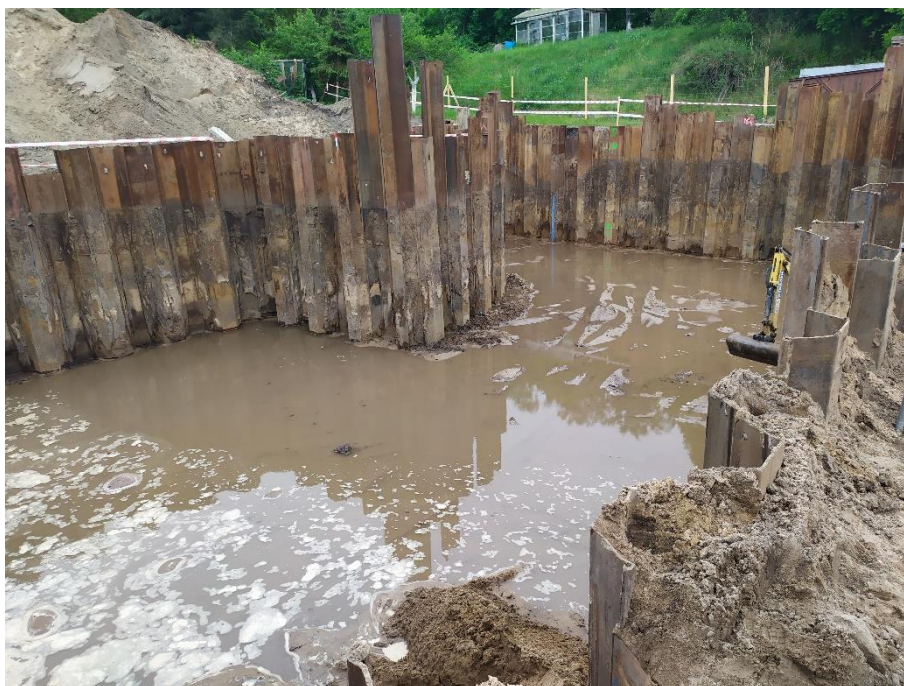
Fot. 8. Wykopy – potencjalne pułapki dla drobnych zwierząt.
