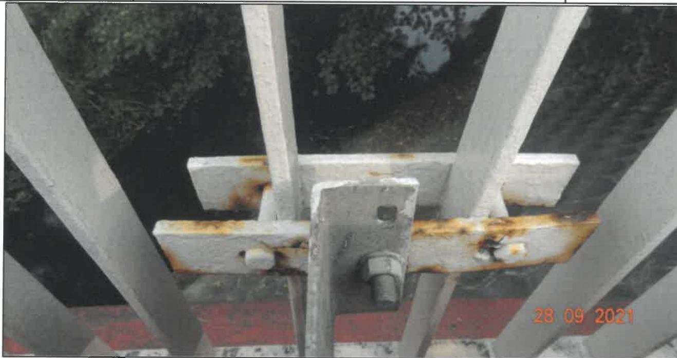
Fot. 16 Balustrady, bariery ochronne Zniszczone zabezpieczenie antykorozyjne oraz korozja elementu łączącego bariery ochronne z balustradą (strona lewa)
