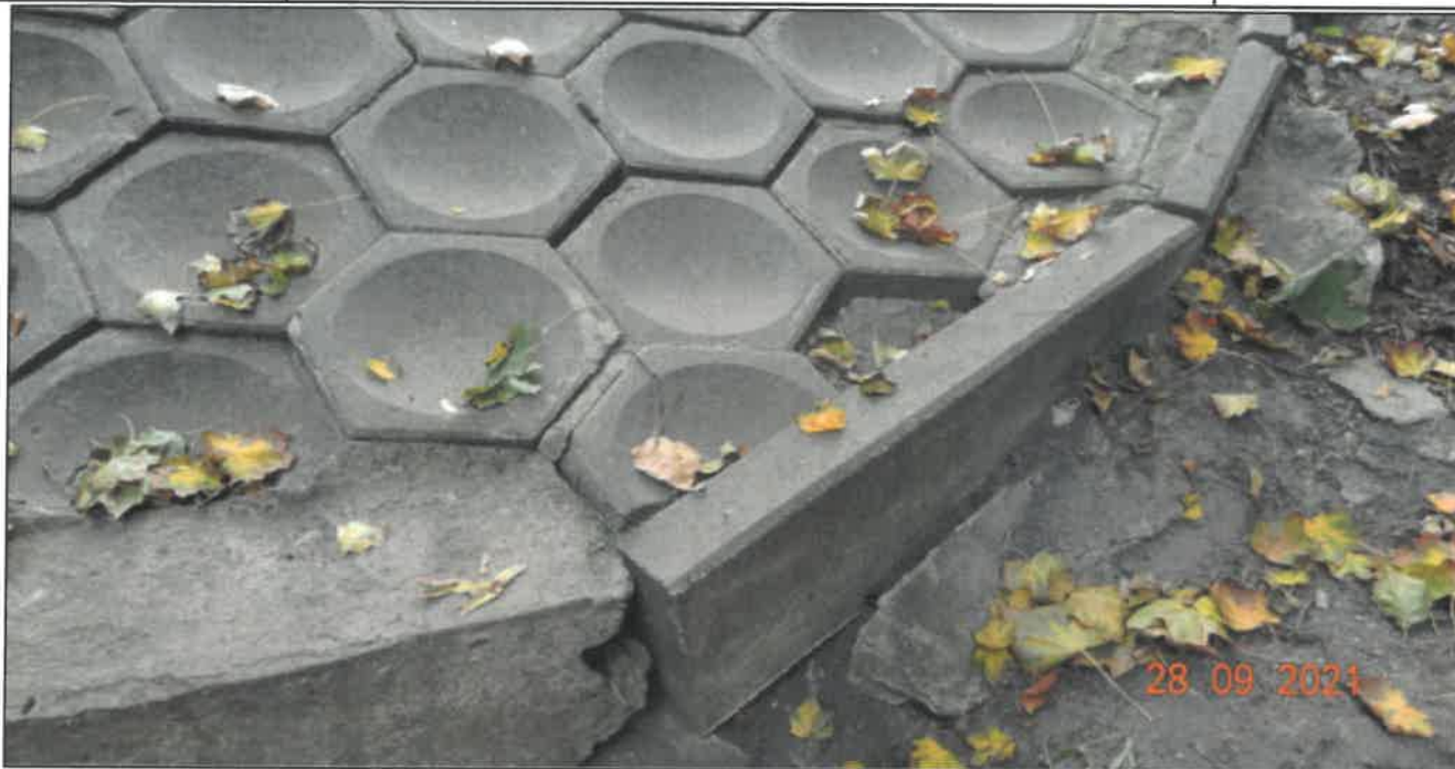
Fot. 12 Nasypy i skarpy Ubytki betonu (podstawa stożka), osiadanie elementów umocnienia stożka, uszkodzenie spoin - strona prawa - stożek nr 2
