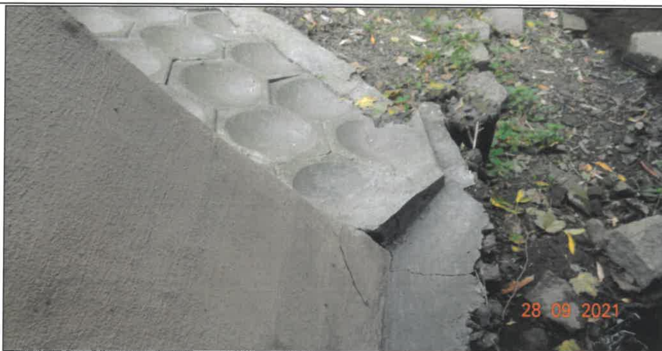
Fot. 23 Przyczółki Zarysowanie betonu (przyczółek zachodni)
