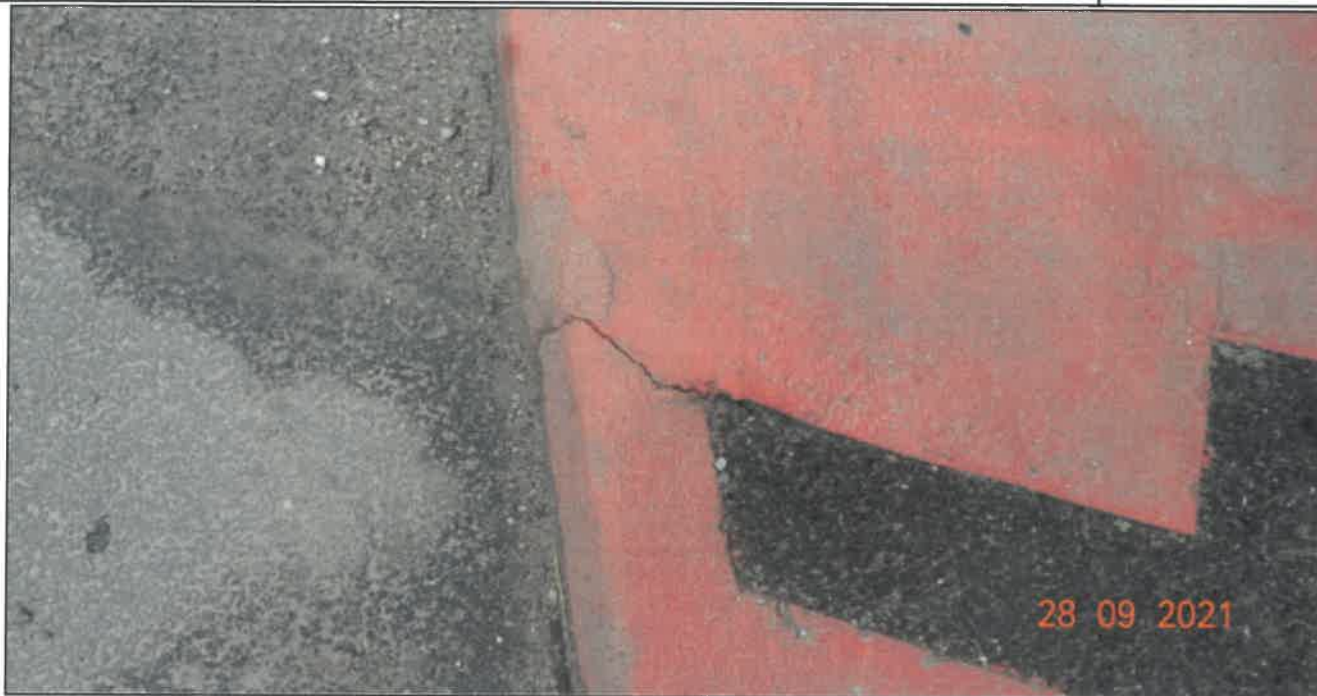
Fot. 14 Wyniesione pobocze techniczne Zarysowanie powierzchni betonowej (strona prawa)
