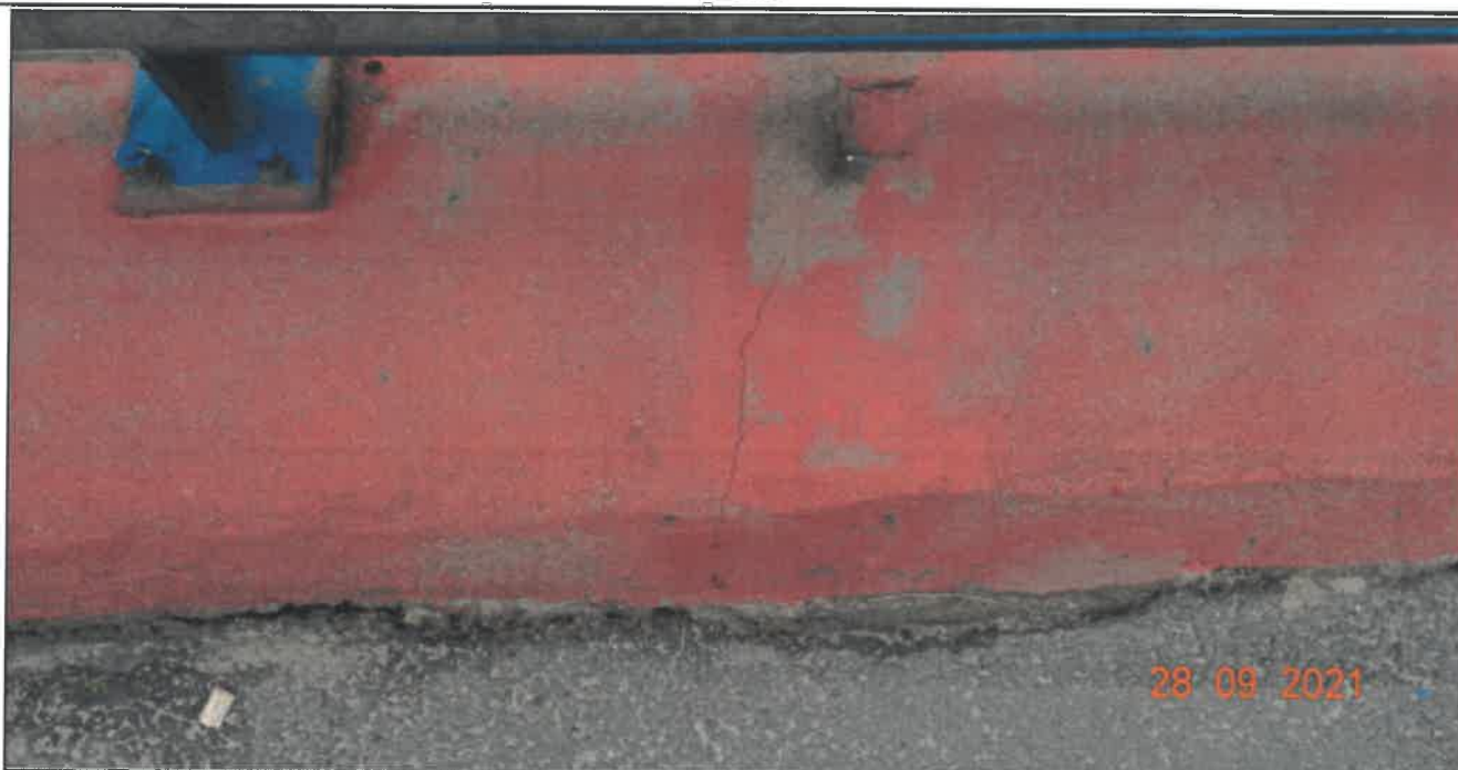
Fot. 13 Wyniesione pobocze techniczne Zarysowanie powierzchni betonowej (strona lewa)
