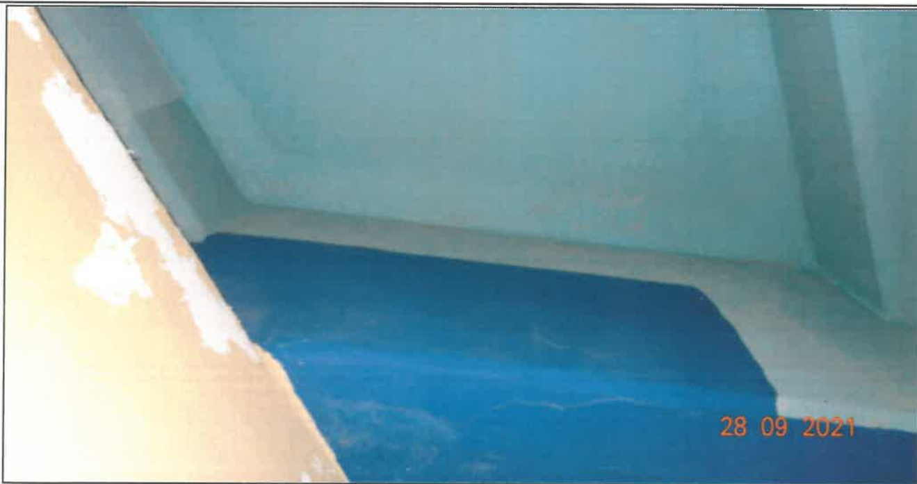
Fot. 45 Konstrukcja dźwigarów głównych Dźwigar nr 4 (przyczółek wschodni) - zarysowania na dolnej powierzchni dźwigara (rysy o rozwarości 0,2 mm ),
