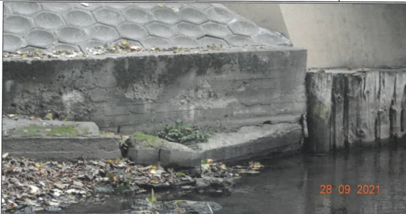
Fot. 10 Nasypy i skarpy Osady, wykwity, korozja betonu (podstawa stożka) - strona prawa - stożek nr 1
