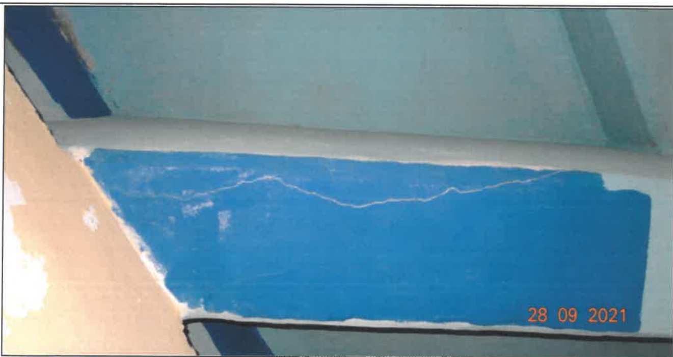
Fot. 41 Konstrukcja dźwigarów głównych Dźwigar nr 2 (przyczółek zachodni) - zarysowania na dolnej powierzchni dźwigara (rysy o rozwarości od 0,2 mm do 1,00 mm), osady i wykwity
