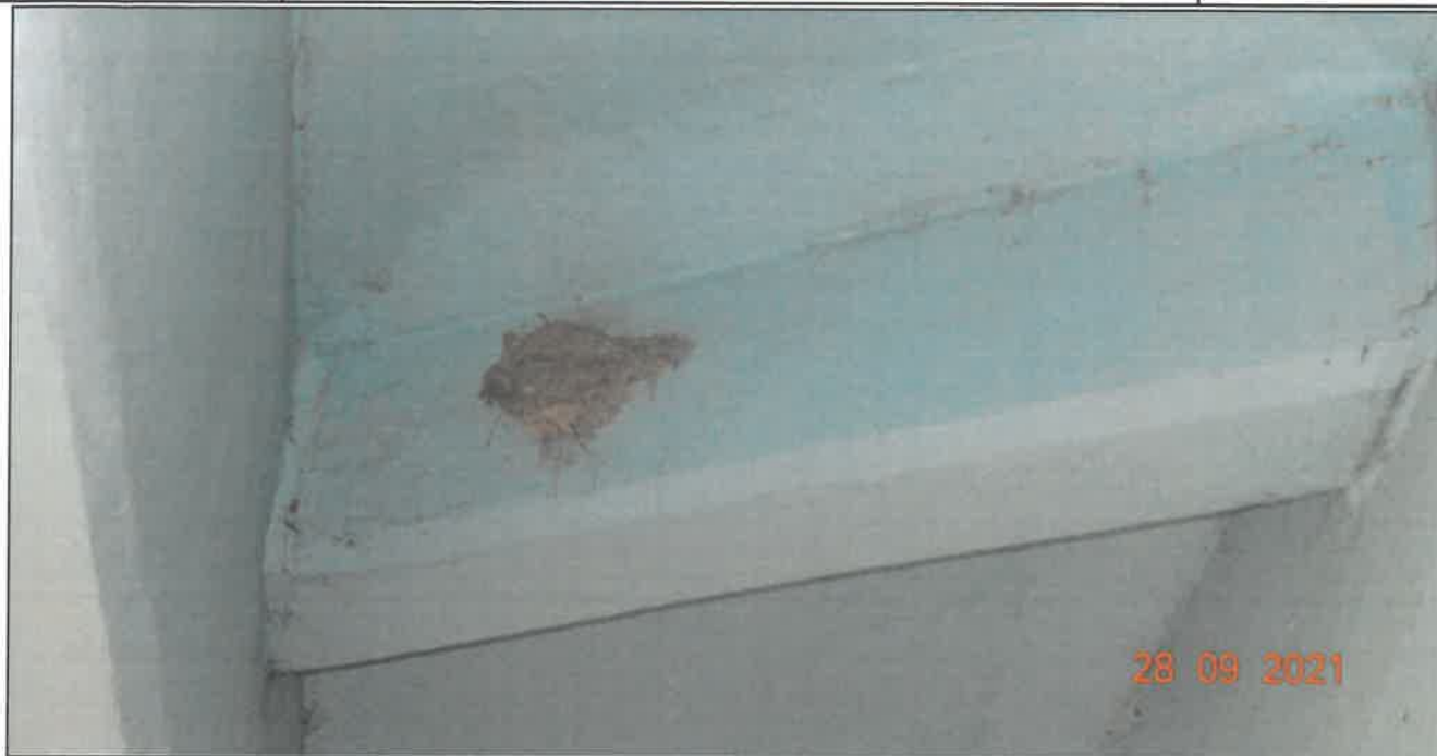
Fot. 26 Konstrukcja dźwigarów Zanieczyszczona poprzecznicą (gniazdo jaskólicze)
