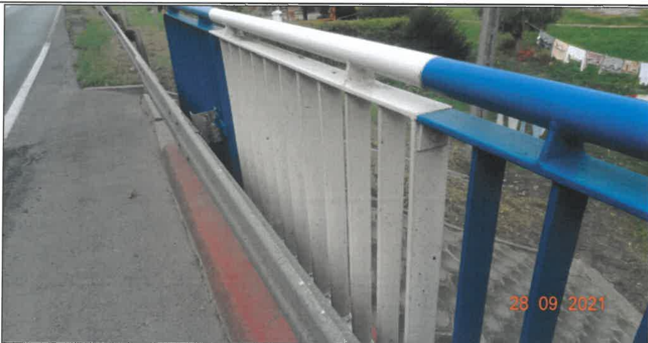
Fot. 15 Balustrady, bariery ochronne Zanieczyszczona powierzchnia balustrady mająca wpływ na estetykę obiektu
