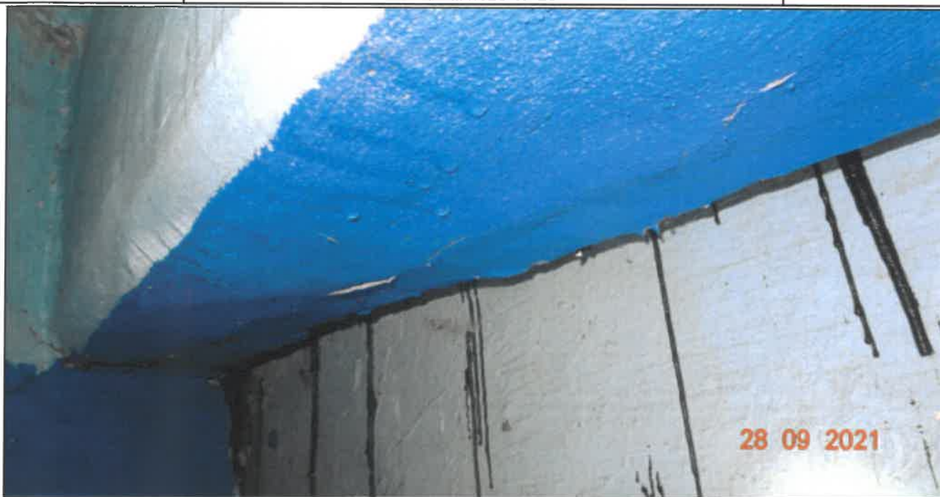
Fot. 46 Konstrukcja dźwigarów głównych Poprzecznica skrajna pomiędzy dźwigarami nr 4 i nr 5 (przyczółek wschodni) - zarysowania powierzchni poprzecznicy (rysy o rozwarości od 0,2 mm do 1,00 mm), przecieki świadczące o nieszczelnej izolacji
