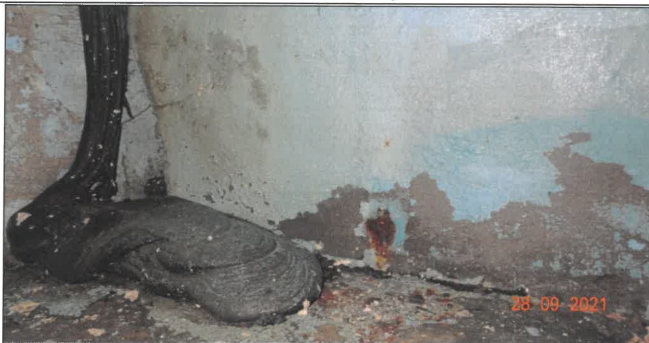
Fot. 51 Konstrukcja dźwigarów głównych Dźwigar nr 7 (przyczółek wschodni) - ślady korozyjne, zniszczenie powłok antykorozyjnych betonu, zastyga masa bitumiczna na ławie łożyskowej (wyciek po naprawie dylatacji)
