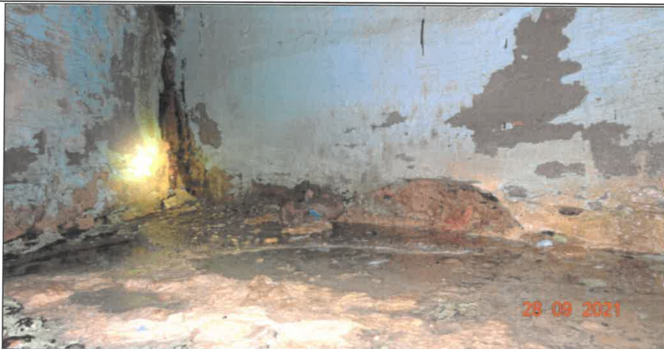
Fot. 25 Przyczółki Przyczółek zachodni (ława łożyskowa) pomiędzy dźwigarami nr 6 i nr 7 - ubytki betonu, zniszczenie zabezpieczeń antykorozyjnych betonu, woda na powierzchni ławy świadczy o nieszczelnej dylatacji
