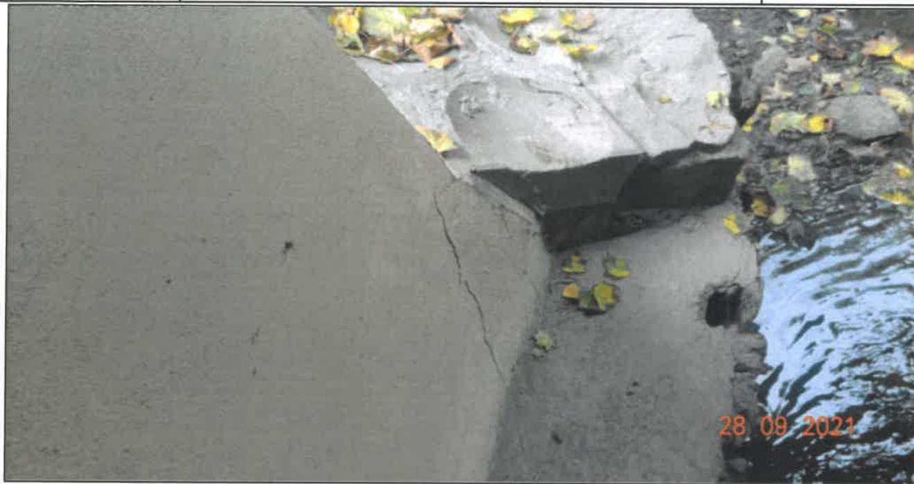
Fot. 24 Przyczółki Zarysowanie betonu (przyczółek wschodni)
