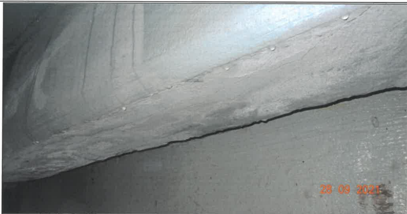
Fot. 43 Konstrukcja dźwigarów głównych Poprzecznicę skrajną pomiędzy dźwigarami nr 3 i nr 4 (przyczółek wschodni) - zarysowania powierzchni poprzecznic (rysy o rozwarości od 0,2 mm do 1,00 mm), przecieki świadczące o nieszczelnej izolacji
