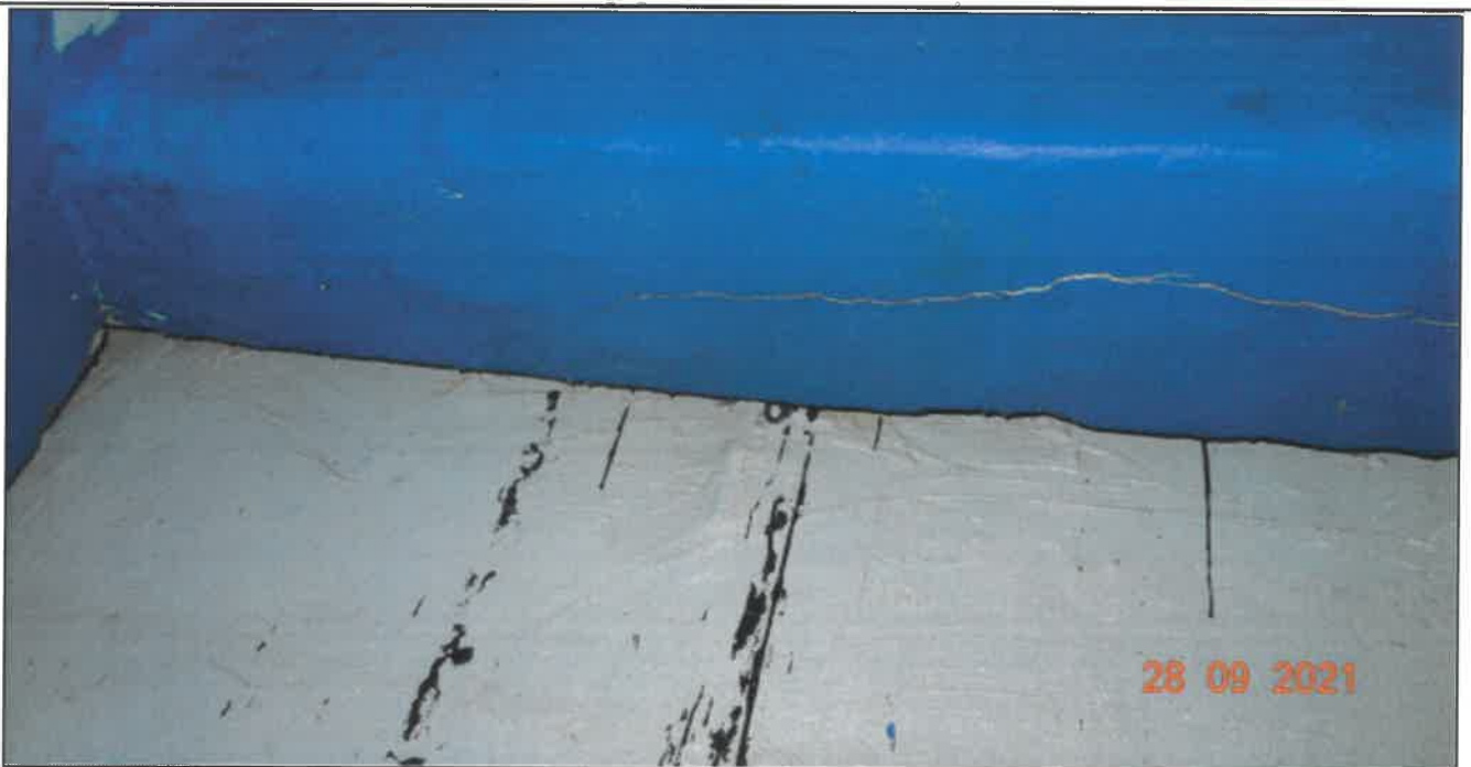
Fot. 33 Konstrukcja dźwigarów głównych Poprzecznicę skrajną pomiędzy dźwigarami nr 4 i nr 5 (przyczółek zachodni) - zarysowania powierzchni poprzecznic (rysy o rozwarości od 0,2 mm do 1,00 mm)
