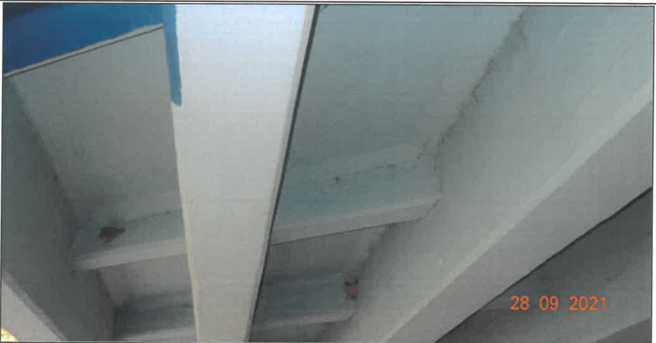
Fot. 21 Konstrukcja pomostu Zanieczyszczona powierzchnia pomostu
