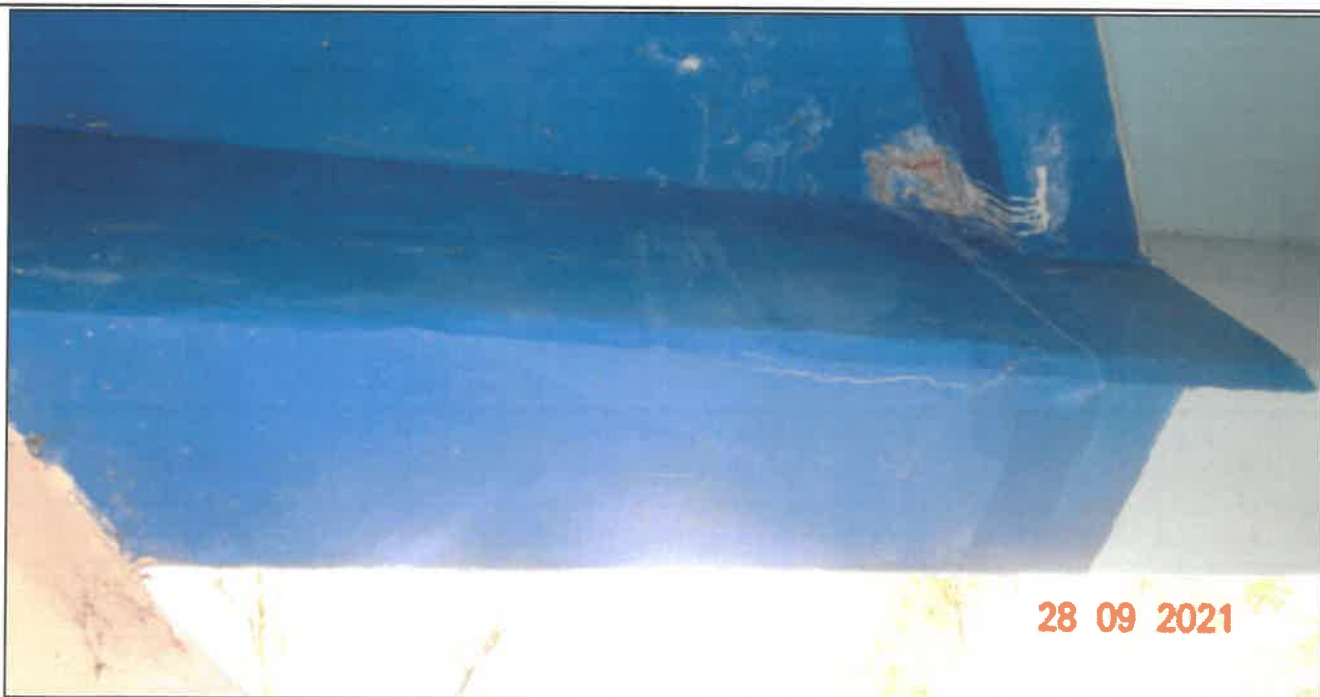
Fot. 19 Izolacja pomostu Punktowy zaciek świadczący o nieszczelnej izolacji
