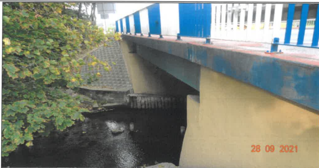
Fot. 17 Belki podporęczowe, gzymsy Zanieczyszczona powierzchnia betonowa gzymsu
