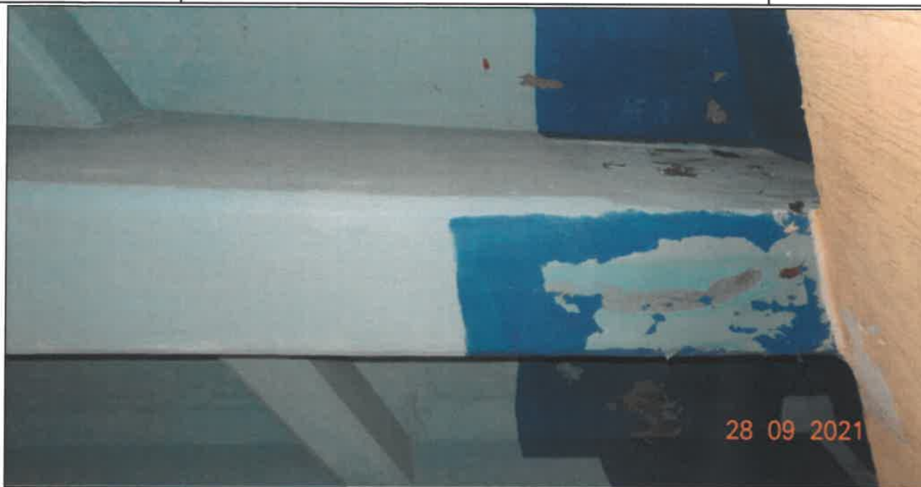
Fot. 36 Konstrukcja dźwigarów głównych Dźwigar nr 6 (przyczółek zachodni) - zarysowania na dolnej powierzchni dźwigara (rysy o rozwarości od 0,2 mm do 1,00 mm), łuszczenie powłok malarskich
