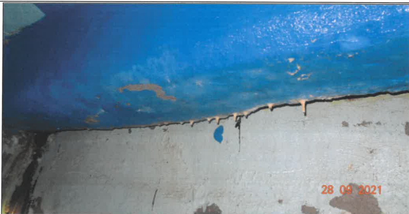
Fot. 37 Konstrukcja dźwigarów głównych Poprzecznicą skrajną pomiędzy dźwigarami nr 6 i nr 7 (przyczółek zachodni) - zarysowania powierzchni poprzecznic (rysy o rozwarości od 0,2 mm do 1,00 mm), osady i wykwity zakończone stalaktytami, łuszczenie powłoki malarskiej
