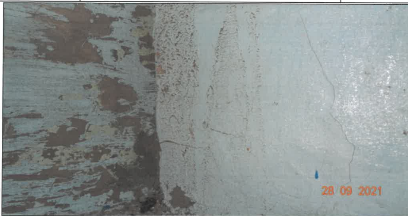
Fot. 40 Konstrukcja dźwigarów głównych Dźwigar nr 2 (przyczółek wschodni) - zarysowania na bocznej powierzchni dźwigara (rysy o rozwarości od 0,2 mm do 1,00 mm), zniszczenie zabezpieczeń antykorozyjnych betonu
