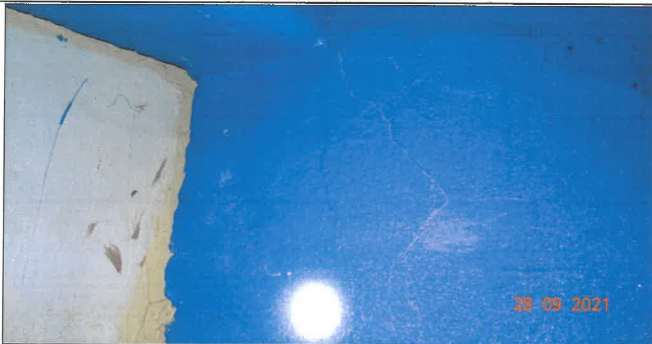
Fot. 31 Konstrukcja dźwigarów głównych Dźwigar nr 3 (przyczółek zachodni) - zarysowania na bocznej powierzchni dźwigara (rysy o rozwarości od 0,2 mm do 1,00 mm)
