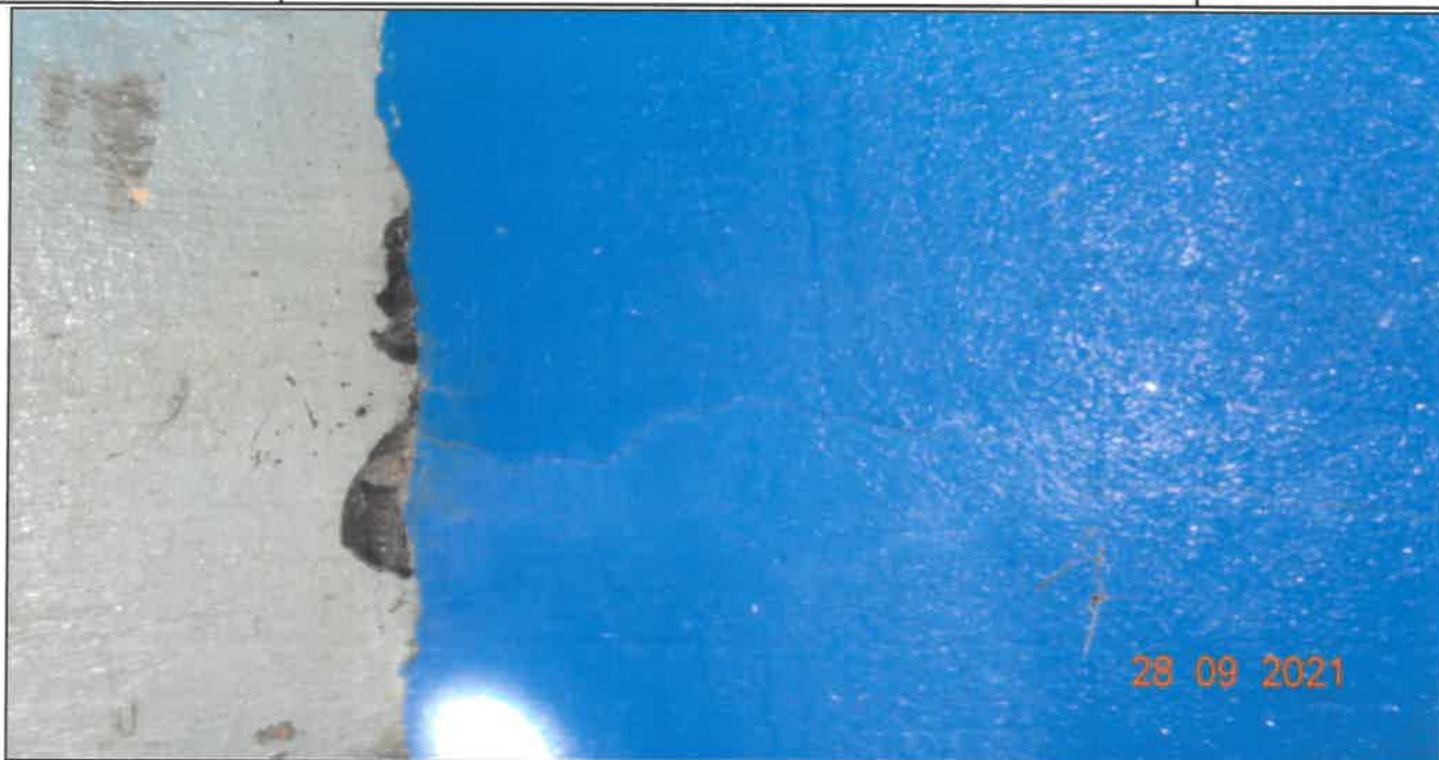
Fot. 44 Konstrukcja dźwigarów głównych Dźwigar nr 4 (przyczółek wschodni) - zarysowania na bocznej powierzchni dźwigara (rysy o rozwarości od 0,2 mm do 1,00 mm), zastygła masa bitumiczna w szczelninie dylatacyjnej uniemożliwiająca swobodne wydłużanie się konstrukcji w okresach wysokiej temperatury
