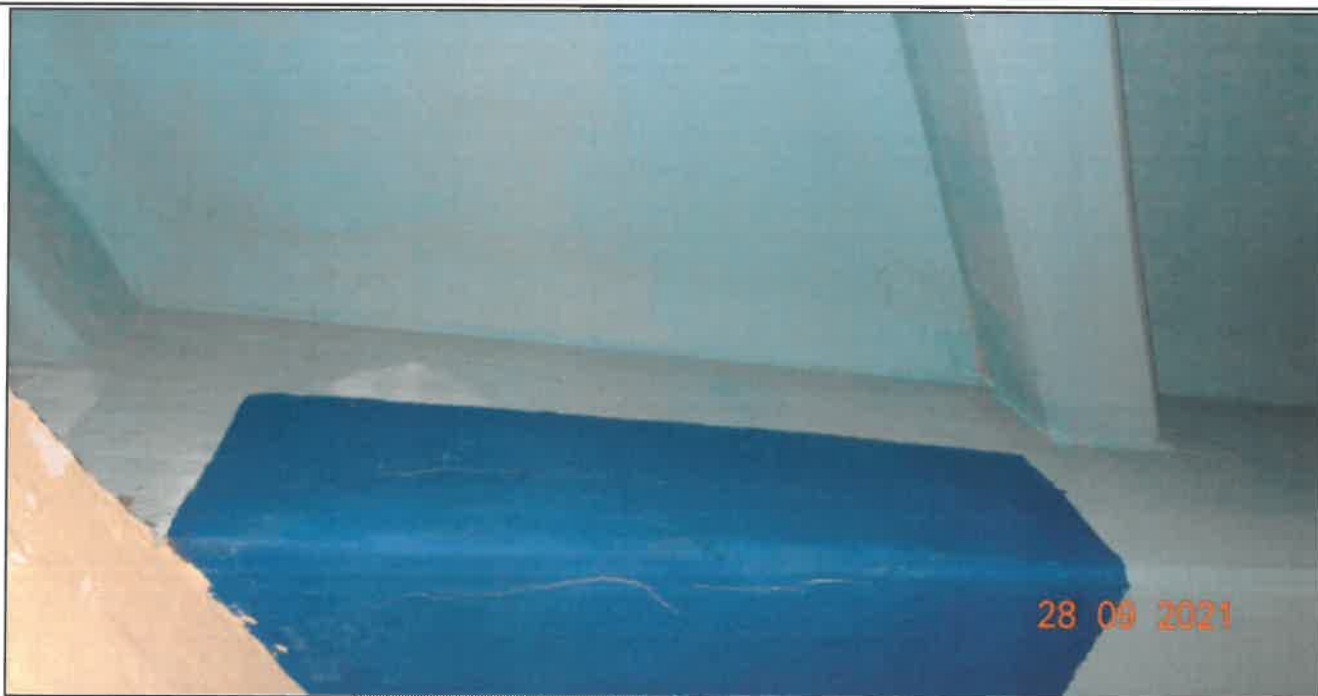
Fot. 29 Konstrukcja dźwigarów głównych Dźwigar nr 2 (przyczółek zachodni) - zarysowania na bocznej i dolnej powierzchni dźwigara (rysy o rozwarości od 0,2 mm do 1,00 mm)
