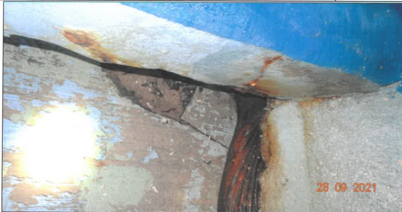
Fot. 50 Konstrukcja dźwigarów głównych Poprzecznicą skrajną między dźwigarami nr 6 i nr 7 (przyczółek wschodni) - ślady korozyjne, zniszczenie powłok antykorozyjnych betonu, masa bitumiczna w szczelnicy dylatacyjnej uniemożliwiająca swobodne wydłużanie się konstrukcji w okresach wysokiej temperatury
