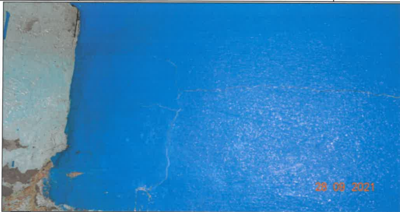
Fot. 34 Konstrukcja dźwigarów głównych Dźwigar nr 5 (przyczółek zachodni) - zarysowania na bocznej powierzchni dźwigara (rysy o rozwarości od 0,2 mm do 1,00 mm)
