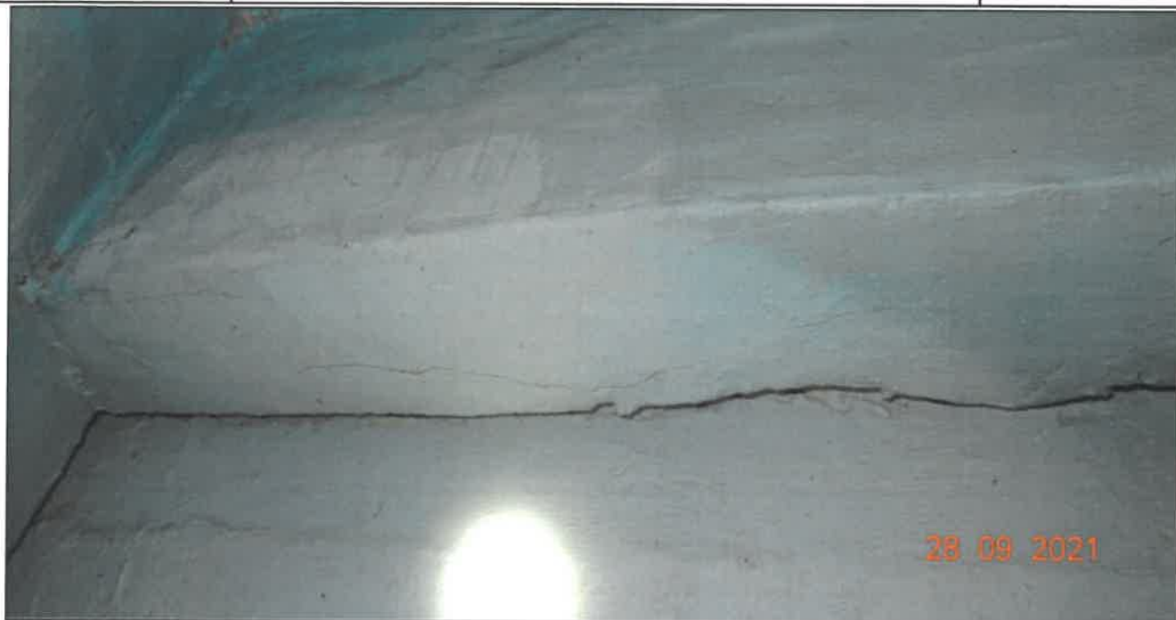
Fot. 30 Konstrukcja dźwigarów głównych Poprzecznicą skrajną pomiędzy dźwigarami nr 2 i nr 3 (przyczółek zachodni) - zarysowania powierzchni poprzecznic (rysy o rozwarości od 0,2 mm do 1,00 mm)
