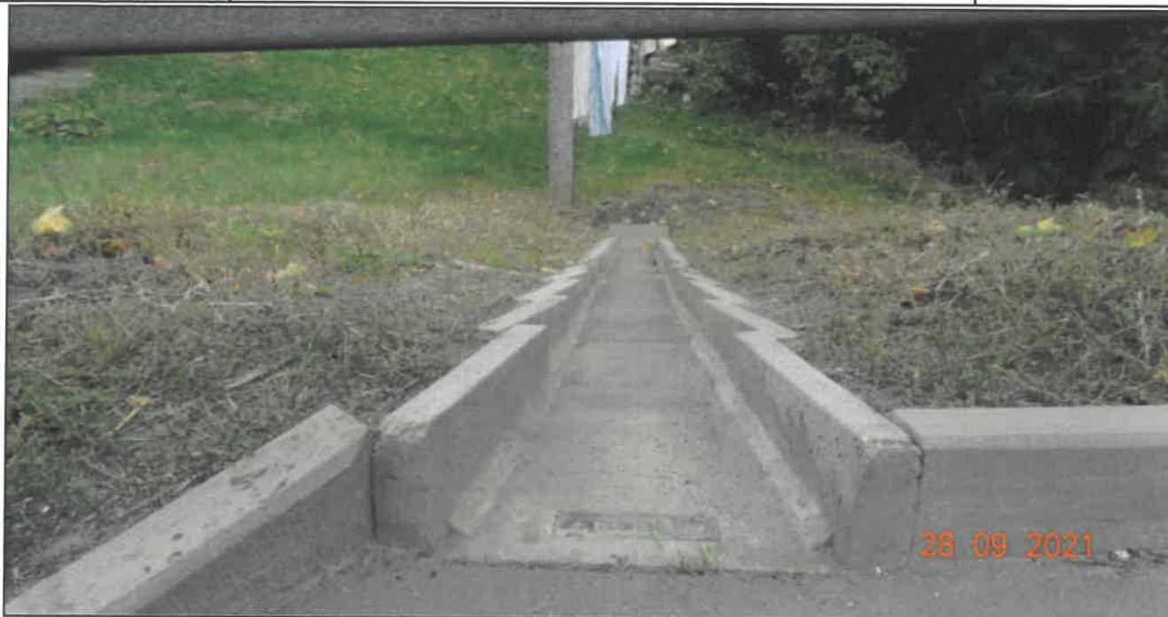
Fot. 18 Urządzenia odwadniające Wegetacja roślin na połączeniu elementów ścieku z nawierzchnią jezdni, wegetacja roślin (strona lewa)
