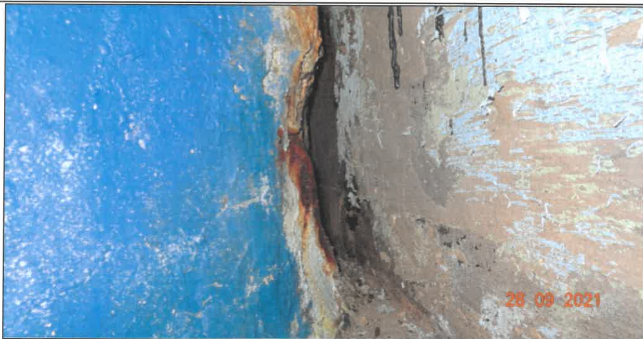
Fot. 39 Konstrukcja dźwigarów głównych Dźwigar nr 1 (przyczółek wschodni) - ubytki betonu oraz korozja odsłoniętego zbrojenia, zniszczenie zabezpieczeń antykorozyjnych betonu
