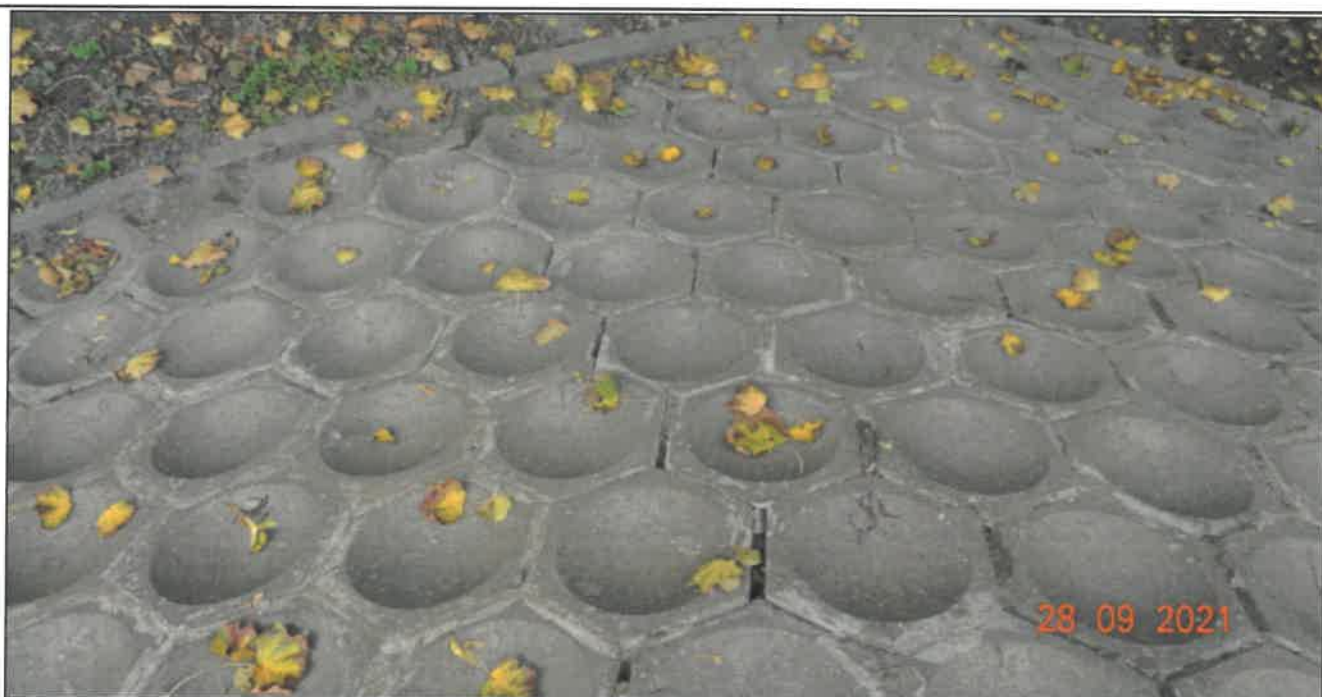
Fot. 11 Nasypy i skarpy Uszkodzenie spoin - strona prawa - stożek nr 2
