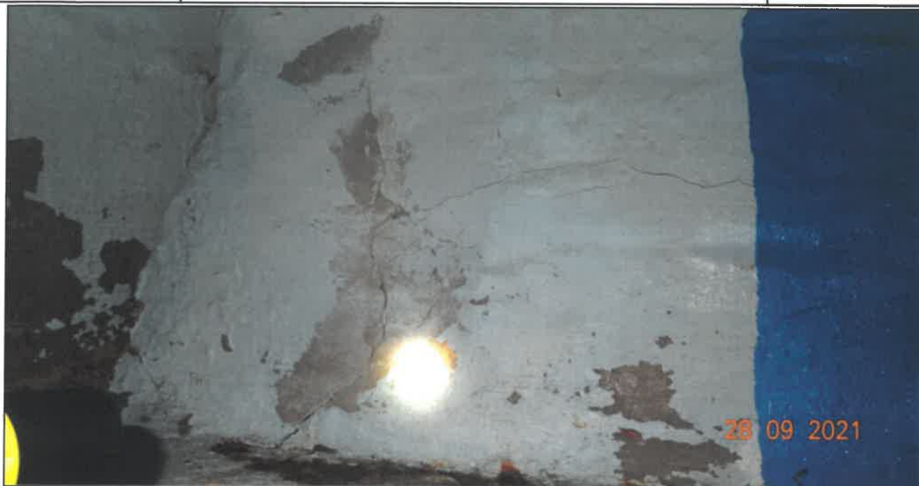
Fot. 28 Konstrukcja dźwigarów głównych Dźwigar nr 2 (przyczółek zachodni) - zarysowania na bocznej powierzchni dźwigara (rysy o rozwarości od 0,2 mm do 1,00 mm)
