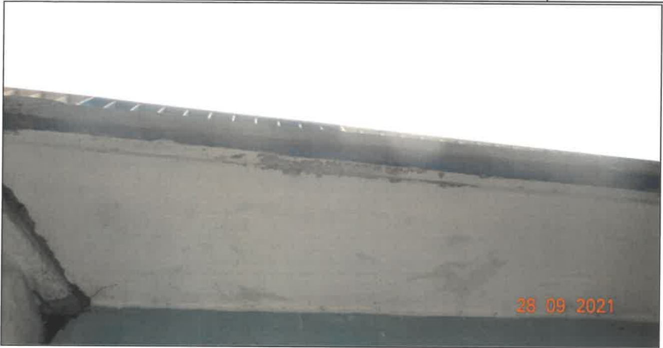
Fot. 20 Konstrukcja pomostu Uszkodzenie powłok antykorozyjnych betonu
