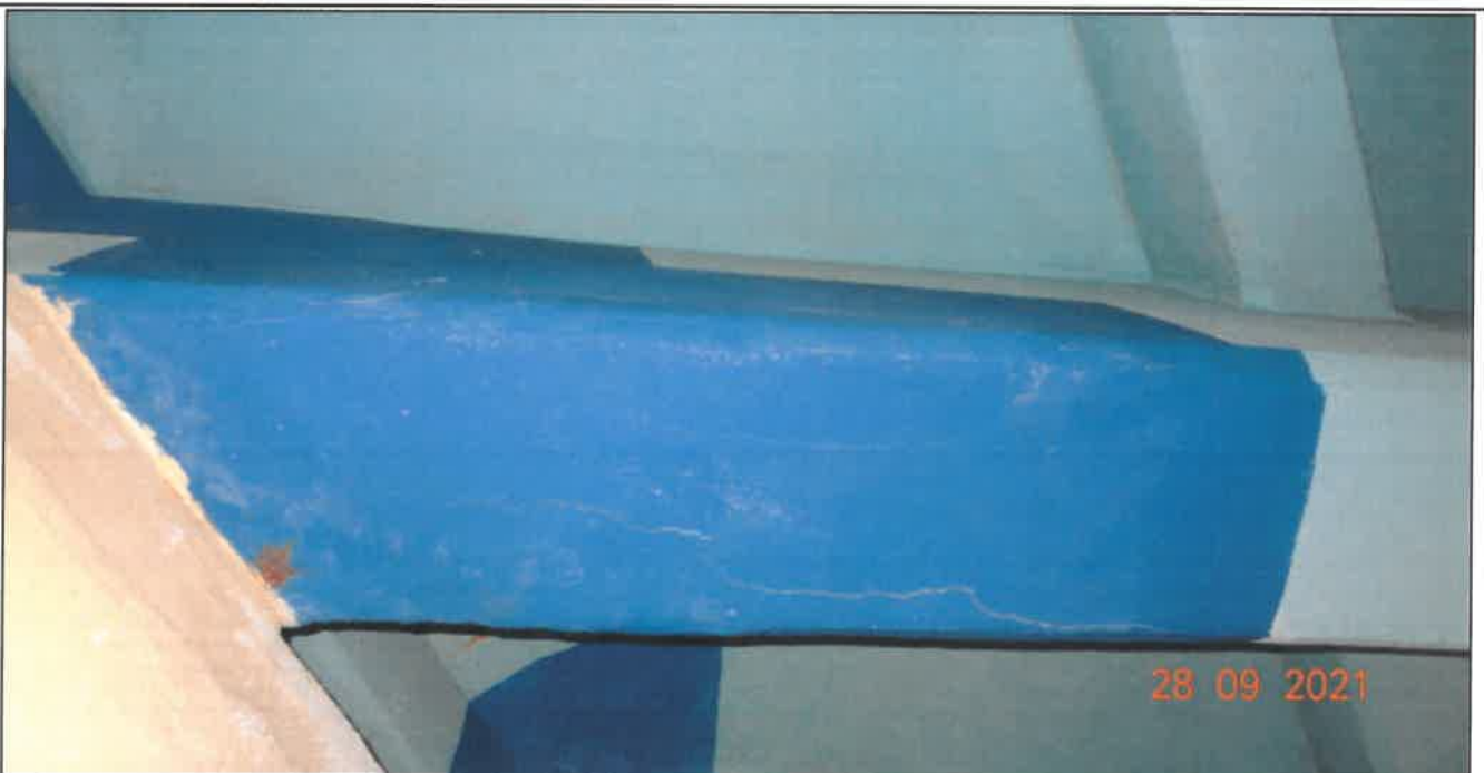
Fot. 49 Konstrukcja dźwigarów głównych Dźwigar nr 6 (przyczółek wschodni) - zarysowania na dolnej powierzchni dźwigara (rysy o rozwarości od 0,2 mm do 1,0 mm ),
