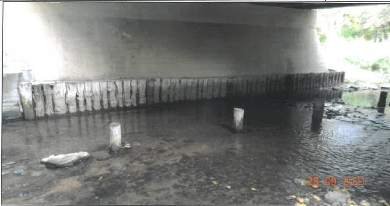
Fot. 22 Przyczółki Ubytki elementów drewnianej palisady, korozja (starzenie) drewna
