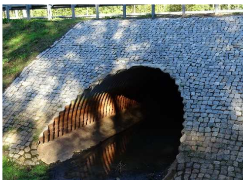
Rys. 4.57. Zniszczenie zabezpieczeń antykorozyjnych, rozległa korozja powłoki stalowej, ubytki materiału
