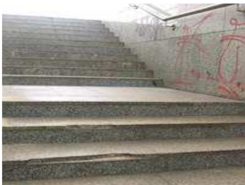
Rys. 3.82. Niewielkie ubytki okładziny kamiennej na schodach do tunelu
