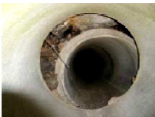
Rys. 4.56. Przemieszczenie sąsiednich elementów przepustu rurowego, zmniejszenie światła o ok. 20%
