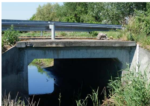
Rys. 4.23. Ubytki, korozja betonu gzymsu
