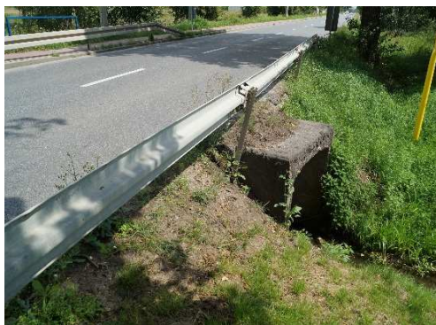
Rys. 4.29. Wadliwy system odwodnienia powierzchniowego, rozmycie skarpy w miejscu zakotwienia słupka bariery ochronnej
