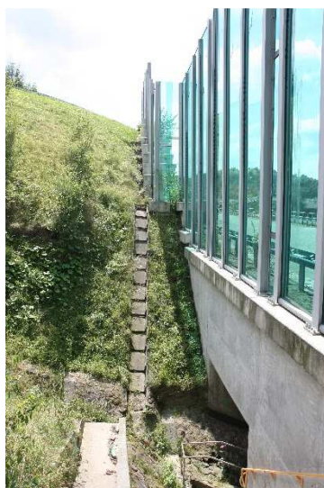
Rys. 5.46. Niewielkie zanieczyszczenia i wegetacja na ściekach skarpowych
