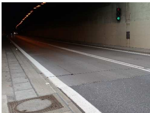
Rys. 3.9. Pojedyncze rysy nawierzchni jezdni w tunelu bez wykruszeń
