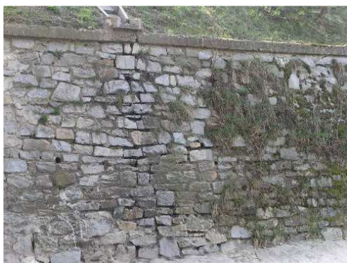
Rys. 5.22. Nieprawidłowe odprowadzenie wody ze ścieku naskarpowego powodujące wypłukiwanie spoin elementów kamiennych i ich przemieszczanie. Wegetacja roślin
