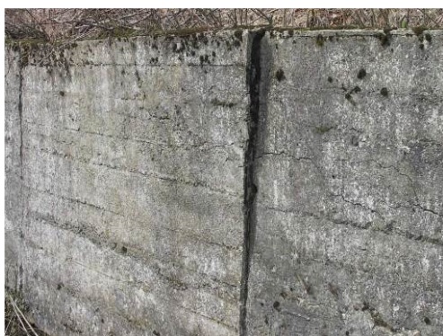
Rys. 5.16. Przemieszczenie konstrukcji oporowej. Z dokumentacji przeglądów wynika, że przemieszczenie wystąpiło wiele lat temu i się nie zmienia. Można więc uznać, że nie ma zagrożenia dla stateczności konstrukcji. Występują rysy poziome, złuszczenia, osady i miejscowa wegetacja roślin
