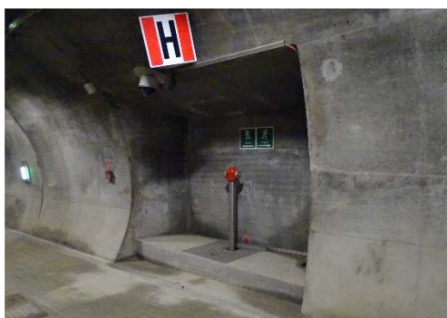
Rys. 3.106. Stan techniczny hydrantu przeciwpożarowego bez zastrzeżeń
