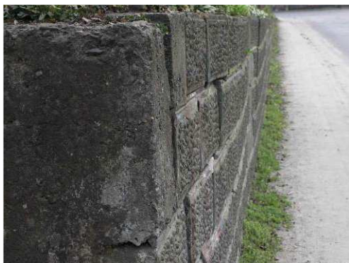
Rys. 5.25. Przemieszczenie elementów konstrukcji niewpływające na trwałość ani stateczność. Wskazane wykonanie przeglądu szczegółowego w celu udokumentowania i zinventaryzowania przemieszczeń
