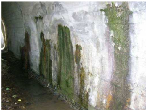
Rys. 4.33. Przecieki i zacieki wody przez ścianę przepustu świadczące o całkowitym uszkodzeniu izolacji
