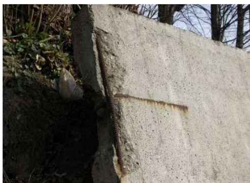
Rys. 5.4. Ubytki gruntu za konstrukcją oporową mające wpływ na stateczność konstrukcji. Ubytki betonu i korozja zbrojenia
