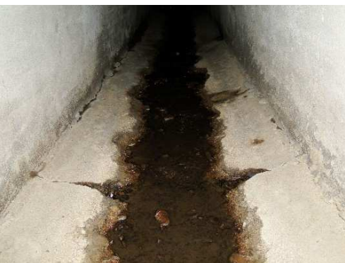
Rys. 4.50. Zniszczenie struktury betonu, ubytki oraz pęknięcia płyty dennej zagrażające nośności przepustu
