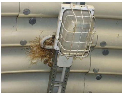
Rys. 3.75. Zanieczyszczenie oraz korozja elementów obudowy oświetlenia niewpływająca na bezpieczeństwo użytkowników
