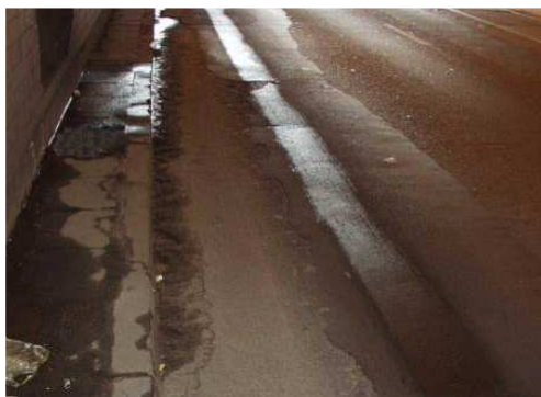
Rys. 3.15. Zanieczyszczenia i zastoiska wody na poboczu technicznym wyniesionym
