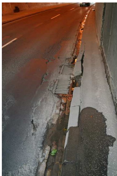
Rys. 3.61. Uszkodzenia ścieku przykrawężnikowego z cegły klinkierowej, ubytki bitumicznego uszczelnienia studzienek kanalizacyjnych
