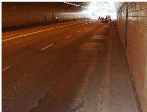
Rys. 3.7. Niewielkie zanieczyszczenia, deformacje do 10 mm
