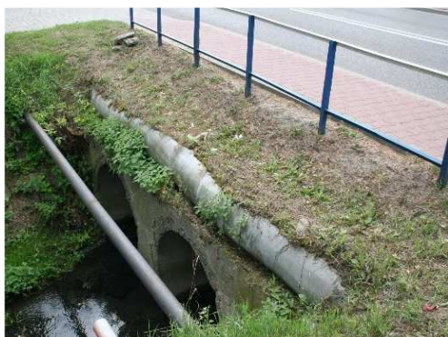
Rys. 4.88. Zanieczyszczona i zdeformowana rura osłonowa ciepłociągu umieszczonego na głowicy przepustu, wegetacja roślin, lokalnie zniszczone zabezpieczenie antykorozyjne i początki korozji
