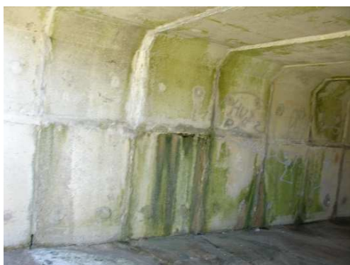
Rys. 4.65. Wegetacja glonów i porostów, lokalne ubytki betonu, przecieki przez styki oraz osady i wylugowania na elementach ramowych przepustu
