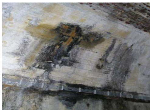
Rys. 3.36. Przecieki, ubytki oraz korozja materiału, osady na ścianie obudowy z cegły
