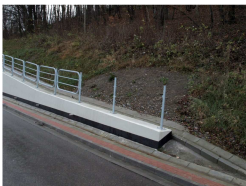
Rys. 5.11. Brak fragmentu balustrady
