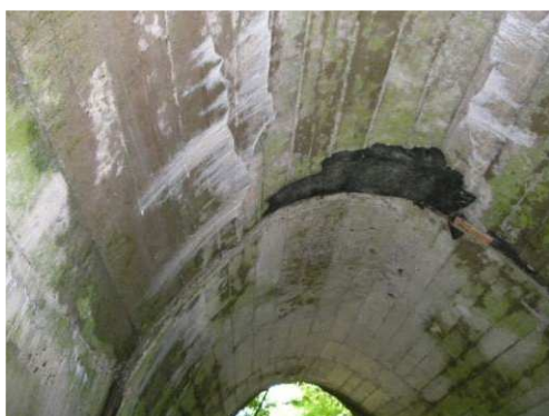
Rys. 4.39. Intensywne przecieki wody, wykwyty, ubytki betonu, początki wegetacji roślin na sklepieniu
