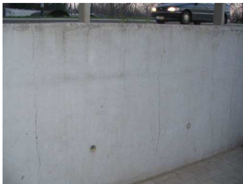
Rys. 5.14. Rysy o rozwarości ok. 0.5 mm w rozstawie ok. 2 m, brak wypełnienia otworu po ściągu deskowania
