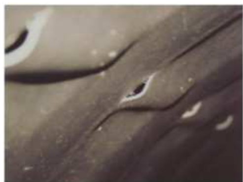
Rys. 4.55. Deformacje, pęknięcia elementu rurowego
