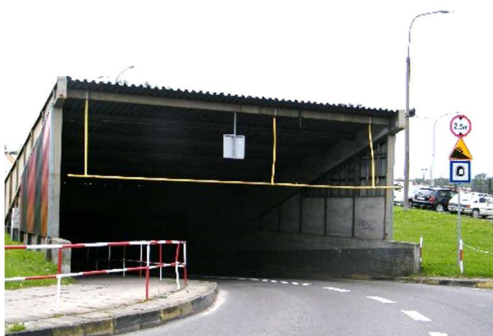
Rys. 3.25. Osłona (zadaszenie) i ogranicznik skrajni na wjeździe do tunelu ze zniszczonymi powłokami antykorozyjnymi. Korozja wżerowa i miejscowe deformacje
