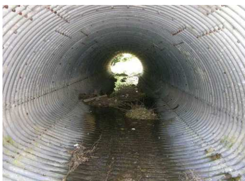
Rys. 4.54. Niewielkie zanieczyszczenia przepustu stalowego – konstrukcji podatnej z blach falistych
