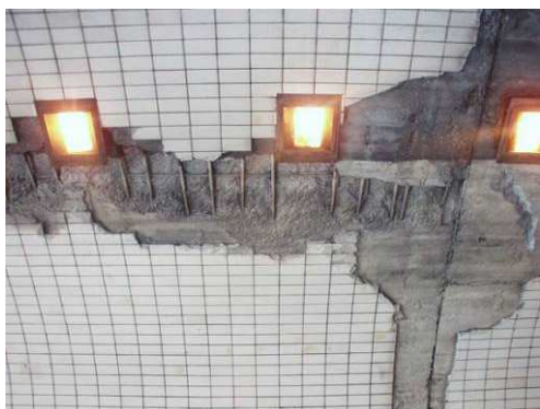
Rys. 3.42. Miejscowe ubytki betonu sklepienia, odłonięte i skorodowane pręty zbrojeniowe
