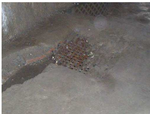
Rys. 3.60. Zanieczyszczona, częściowo niedrożna kratka ściekowa
