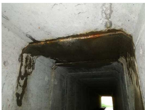
Rys. 4.35. Lokalny przeciek przez dwa styki/złącza prefabrykowanych elementów przepustu ramowego/skrzynkowego
