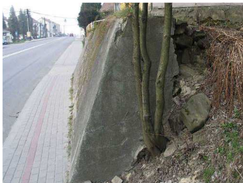
Rys. 5.5. Wyptukanie gruntu, ubytki kamienia (zasyпки konstrukcji oporowej), rosnące drzewa mogące spowodować dodatkowe uszkodzenia konstrukcji oporowej
