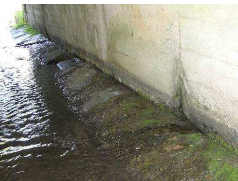
Rys. 4.49. Niewielkie ubytki materiału płyty dennej sklepienia
