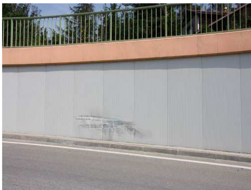
Rys. 5.40. Konstrukcja oporowa wykonana z prefabrykatów stalowych (ścianka szczelna) z betonowym zwieńczeniem i obudową z blach. Widoczne miejscowe uszkodzenie (otarcie) obudowy
