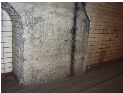
Rys. 3.56. Odpadanie elementów okładziny ze ścian tunelu
