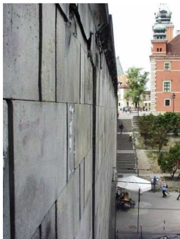
Rys. 3.32. Przemieszczenie głowicy ściany czołowej o ok. 50 mm przy wysokości ściany 7 m
