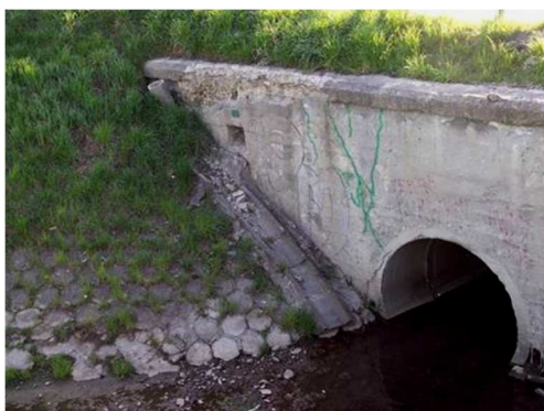
Rys. 4.24. Ubytki betonu gzymsu, odstąpięte, skorodowane zbrojenie
