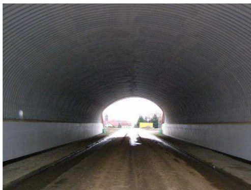
Rys. 3.11. Zanieczyszczenie nawierzchni, zastoiska wody na jezdni oraz w strefach ścieków przykrawężnikowych
