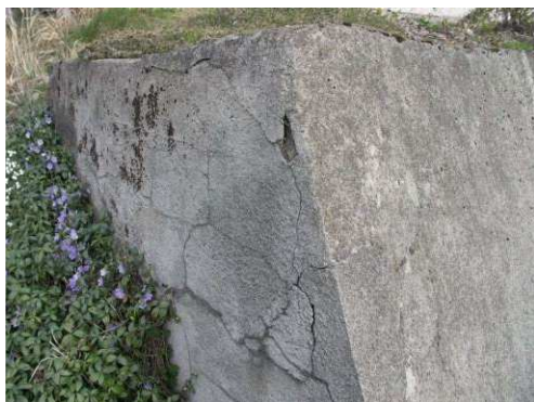
Rys. 5.15. Miejscowe zniszczenie struktury materiału
