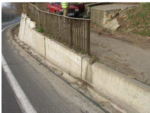
Rys. 5.9. Całkowite zniszczenie powłoki anty-korozyjnej, początki korozji balustrady
