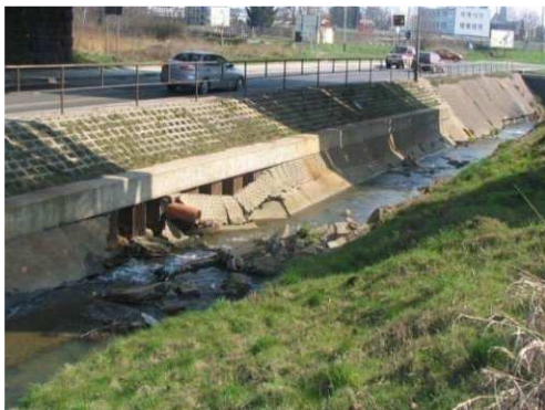
Rys. 5.41. Widoczne uszkodzenie obudowy z płyt żelbetowych. Stalowy korpus konstrukcji nieuszkodzony
