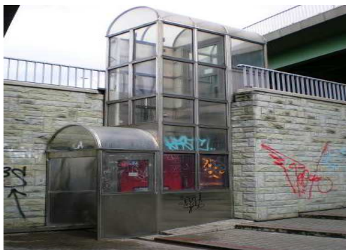
Rys. 3.100. Zanieczyszczenia obudowy szybu windy (graffiti) w przejściu podziemnym
