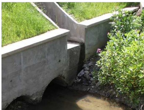
Rys. 4.26. Odwodnienie sprawnie działające, bez uszkodzeń, niewielkie zanieczyszczenia. Wskazane jest wykonanie krótkiego ścieku na skarpie
