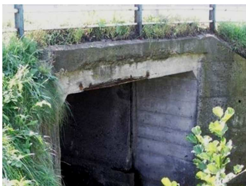
Rys. 4.66. Miejscowe ubytki betonu i korozja zbrojenia
