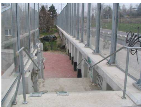
Rys. 5.65. Zanieczyszczenia ekranu przeciwhałasowego spowodowane ochlapywaniem przez pojazdy oraz graffiti
