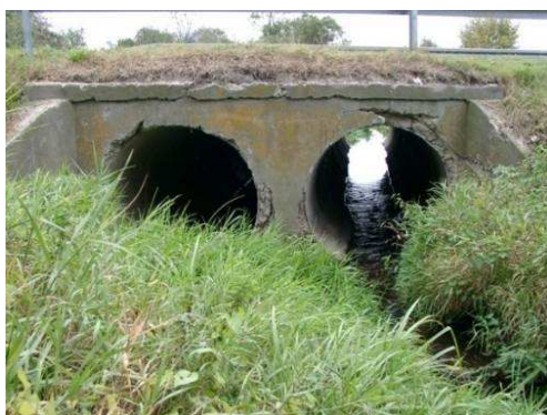
Rys. 4.70. Ubytki betonu i korozja zbrojenia głowicy
