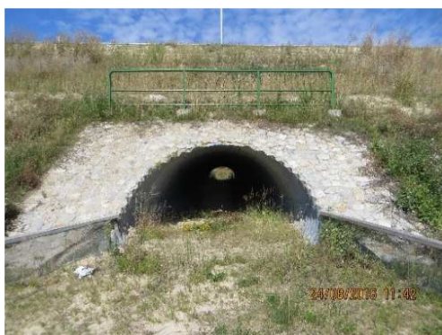
Rys. 4.5. Wegetacja roślinności na skarpie wymagająca prac pielęgnacyjnych, zanieczyszczenie na kamiennym umocnieniu skarpy, lokalne uszkodzenie powłoki nawierzchniowej na balustradzie
