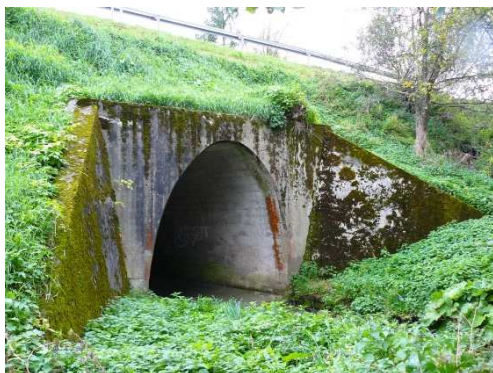
Rys. 4.68. Intensywna wegetacja mchów na głowicy przepustu sklepionego. Zagrożenie korozją biologiczną betonu ścianki czołowej i skrzydeł
