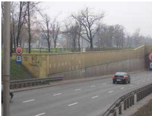
Rys. 3.48. Nieliczne zanieczyszczenia (graffiti) występujące na ścianie oporowej
