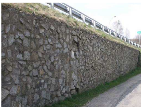
Rys. 5.28. Ubytki kamienia z korpusu konstrukcji
