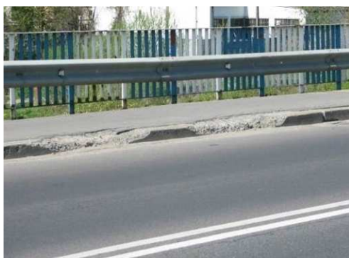
Rys. 4.16. Uszkodzenie ok. 50% krawężników nad przepustem
