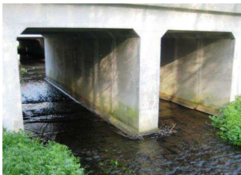
Rys. 4.63. Niewielkie zanieczyszczenia, początki wegetacji roślin
