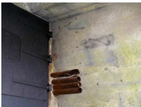
Rys. 3.98. Pozostałość po urządzeniach obcych, wskazany demontaż elementów
