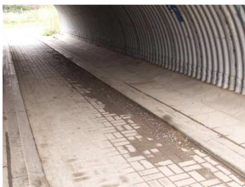
Rys. 3.63. Odwodnienie powierzchniowe przejścia podziemnego ze zbyt małymi spadkami, zanieczyszczenia i zastoiska wody wzdłuż ścieków przykrawężnikowych
