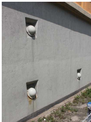
Rys. 5.61. Miejscowa, powierzchniowa korozja obudowy/osłon zakotwień
