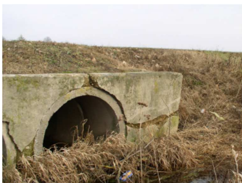
Rys. 4.71. Rysy i pęknięcia głowicy, przemieszczenie fragmentu głowicy wlotowej
