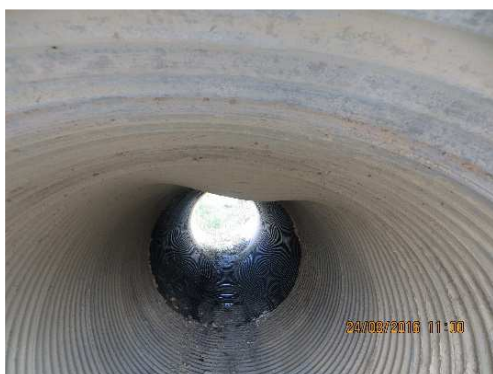
Rys. 4.59. Deformacja i przemieszczenie powłoki stalowej przepustu z blach falistych, zmniejszenie światła o ok. 20%
