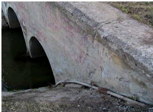
Rys. 4.84. Uszkodzenia osłony i zamocowania kabla telekomunikacyjnego
