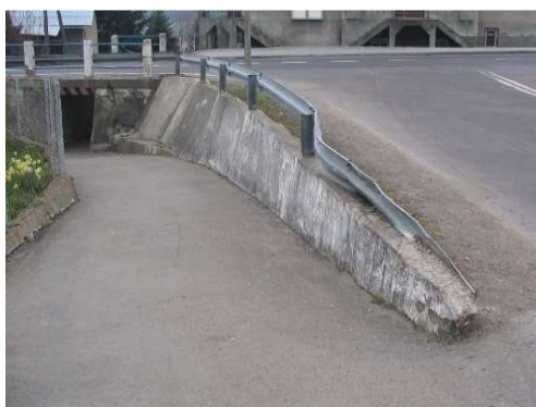
Rys. 5.10. Zdeformowana bariera, uszkodzone połączenie bariery ze słupkami
