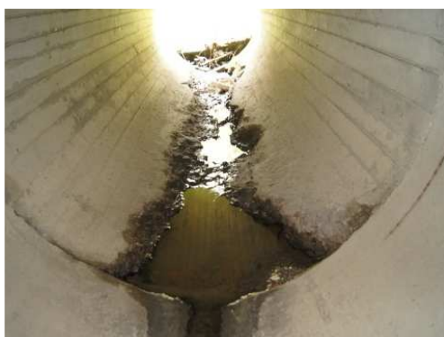
Rys. 4.60. Obszerne ubytki i zniszczenie struktury betonu monolitycznego przepustu o konstrukcji rurowej zagrażające nośności przepustu
