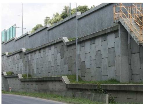
Rys. 5.55. Gzymsy na konstrukcji oporowej bez uszkodzeń
