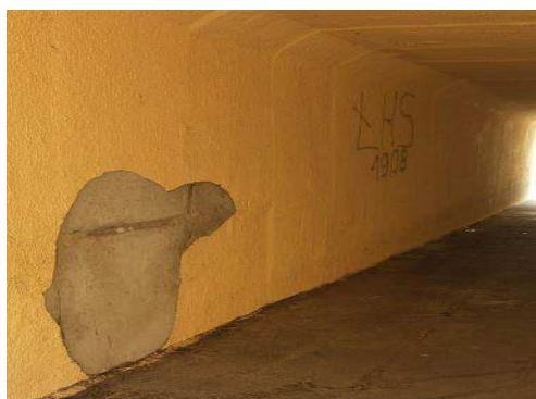
Rys. 3.35. Zanieczyszczenia, ubytki tynku spowodowane złym wykonawstwem
