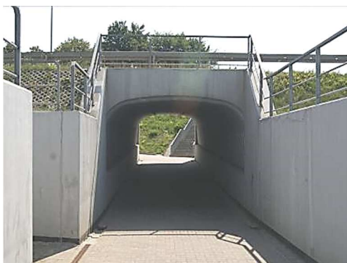
Rys. 3.53. Konstrukcje oporowe niepołączone monolitycznie z głowicami obiektu, brak uszkodzeń
