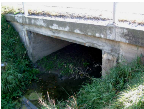
Rys. 4.48. Zanieczyszczona płyta denna – utrudniony przepływ wody
