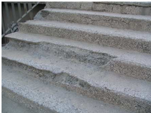
Rys. 3.83. Ubytki oraz pęknięcia betonu na schodach do przejścia podziemnego, uszkodzenie zagrażające bezpieczeństwu pieszych
