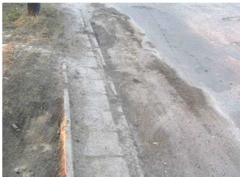
Rys. 4.10. Zanieczyszczenia jezdni nad przepustem utrudniające przepływ wody
