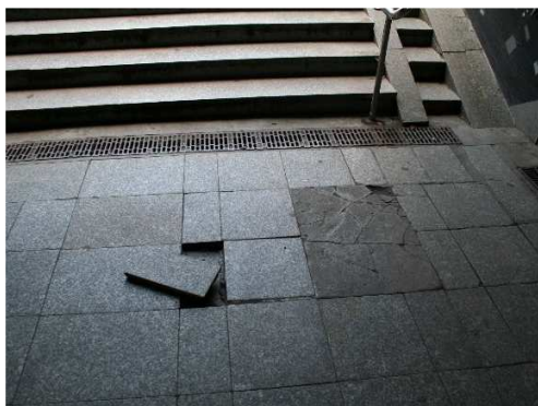
Rys. 3.18. Ubytki elementów kamiennych i nierówności nawierzchni w przejściu podziemnym
