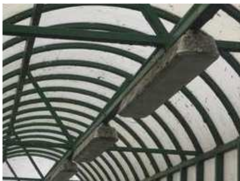
Rys. 3.72. Zanieczyszczenia elementów oświetlenia
