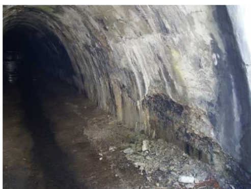
Rys. 4.40. Zaawansowana degradacja betonu sklepienia, korozja i ubytki betonu, osady i wykwyty, przecieki
