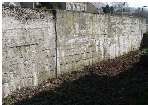
Rys. 5.48. Korozja ługująca świadcząca o braku skutecznej izolacji
