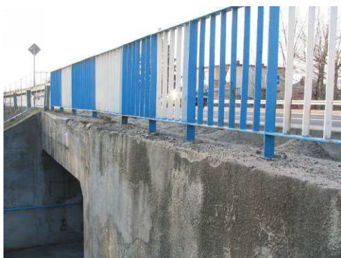
Rys. 3.29. Zarysowania betonu na ścianie czołowej, wykwyty świadczące o korozji ługującej na ok. 30% powierzchni oraz ubytki betonu
