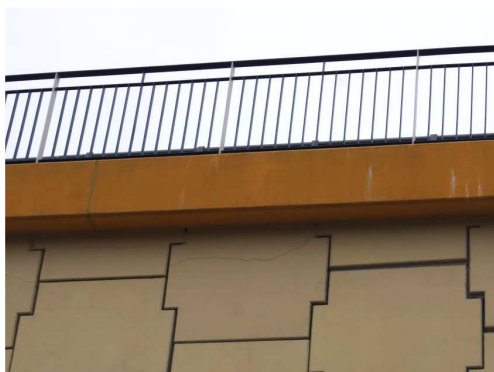
Rys. 5.31. Rysy o rozwarości 0.6 mm na dwóch prefabrykacie konstrukcji (mały zakres uszkodzeń, rysy ustabilizowane)
