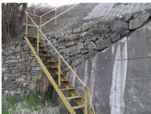
Rys. 5.58. Brak przeciągu balustrady oraz miejscowe uszkodzenie powłoki antykorozyjnej
