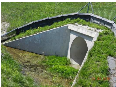
Rys. 4.76. Głowica przepustu rurowego – nie- wielkie zanieczyszczenie ścianki czołowej, skrzydeł, wegetacja na betonie płyty dennej
