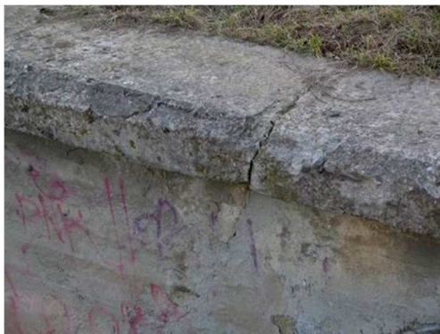
Rys. 4.22. Ubytki betonu, pęknięcia, powierzchniowa korozja betonu, wegetacja roślin (mchy) zagrażające trwałości
