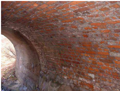
Rys. 4.37. Osady i wykwyty oraz niewielkie ubytki materiału konstrukcji
