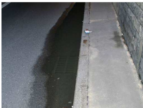
Rys. 3.62. Zanieczyszczenie powodujące całkowitą niedrożność pojedynczego urządzenia odwadniającego
