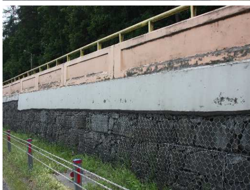
Rys. 5.12. Zniszczenie powłoki malarskiej na barierze betonowej, osady i złuszczenia betonu
