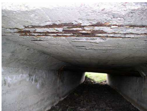
Rys. 4.38. Widoczne ubytki betonu i korozja zbrojenia w płycie górnej przepustu ramowniczego
