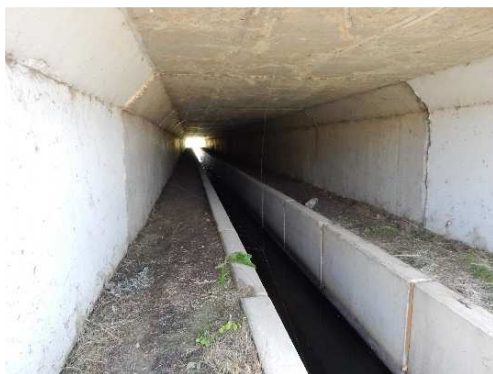
Rys. 4.91. Przepust skrzynkowy zintegrowany z przejściem dla małych zwierząt z półkami betonowymi wypełnionymi gruntem bez uszkodzeń
