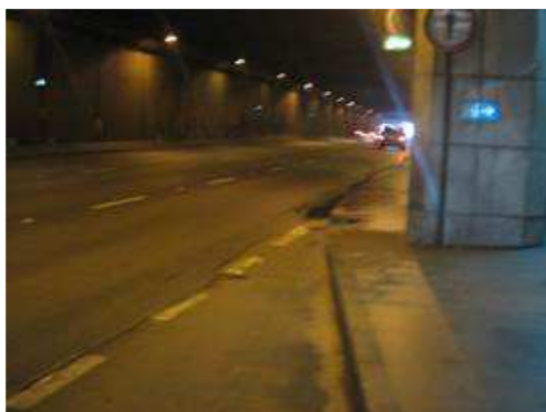
Rys. 3.16. Zanieczyszczenia i zastoiska wody na chodnikach
