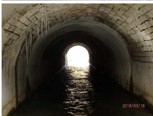
Rys. 4.41. Przecieki przez sklepienie ceglane, ubytki wypełnienia spoin, osady i wykwyty na powierzchni sklepienia
