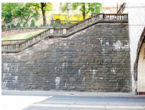
Rys. 3.52. Przecieki, wykwity, korozja i ubytki elementów kamiennych
