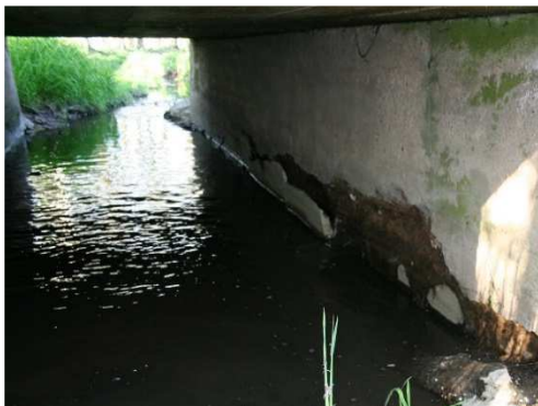
Rys. 4.44. Korozja i ubytki materiału ściany obniżające nośność przepustu, rysy i zawilgoce nie ścian
