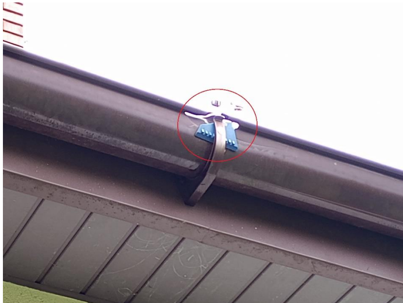
Fot. 5 Budynek mieszkalny – uszkodzenia rynny
