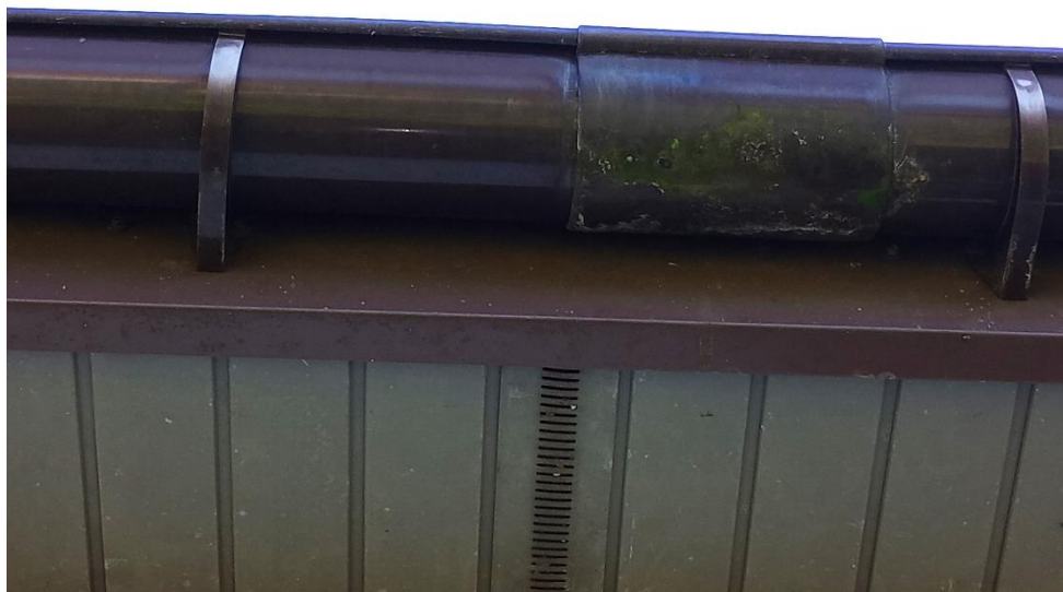
Fot. 6 Budynek mieszkalny – uszkodzenia rynny
