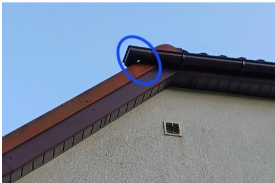
Fot. 7 Budynek mieszkalny – uszkodzony (pęknięty) narożnik rynny
