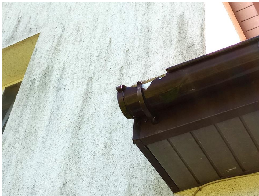
Fot. 4 Budynek mieszkalny – uszkodzenia rynny
