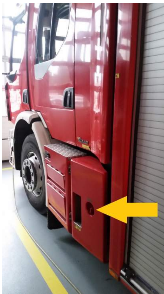
Rys. 95. Główny wyłącznik prądu w okolicy umieszczenia akumulatorów
