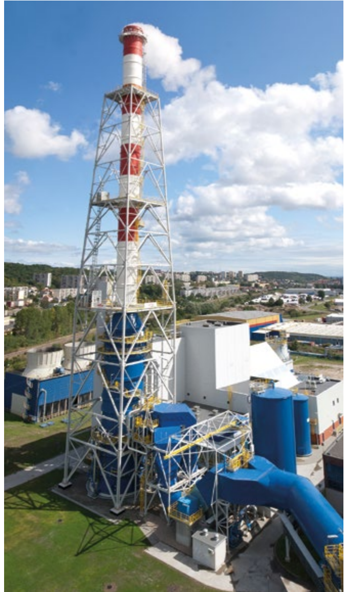
Instalacja odsiarczania spalin (IMOS) w EC Gdyńskiej
