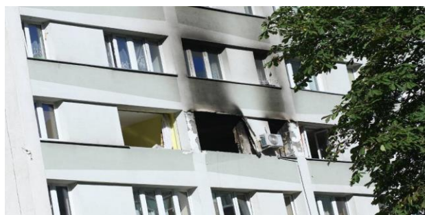
Zniszczenia budynku po wybuchu gazu przy ul. Noakowskiego – fot. www.warszawa.tvp.pl
