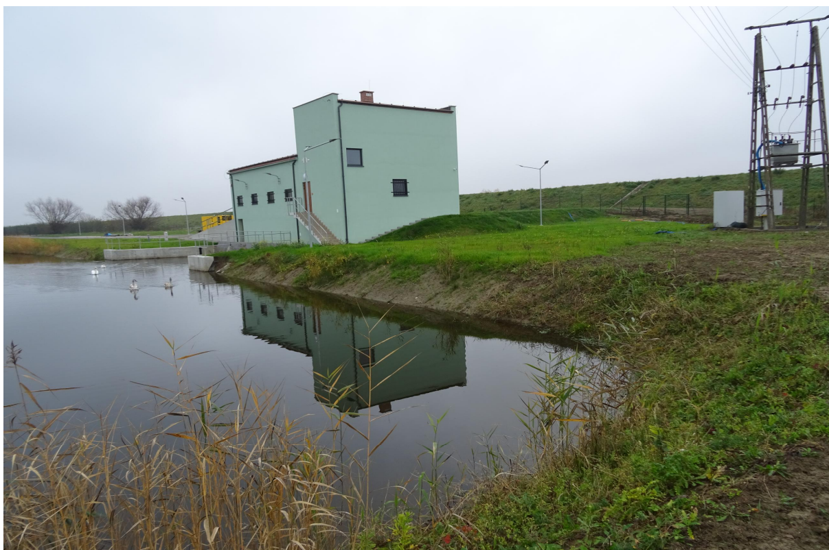
Fotografia 7. Podzadanie 2 - Zrealizowana budowa przepompowni Nadbrzezie – widok ogólny (źródło: materiały własne PGW WP).
