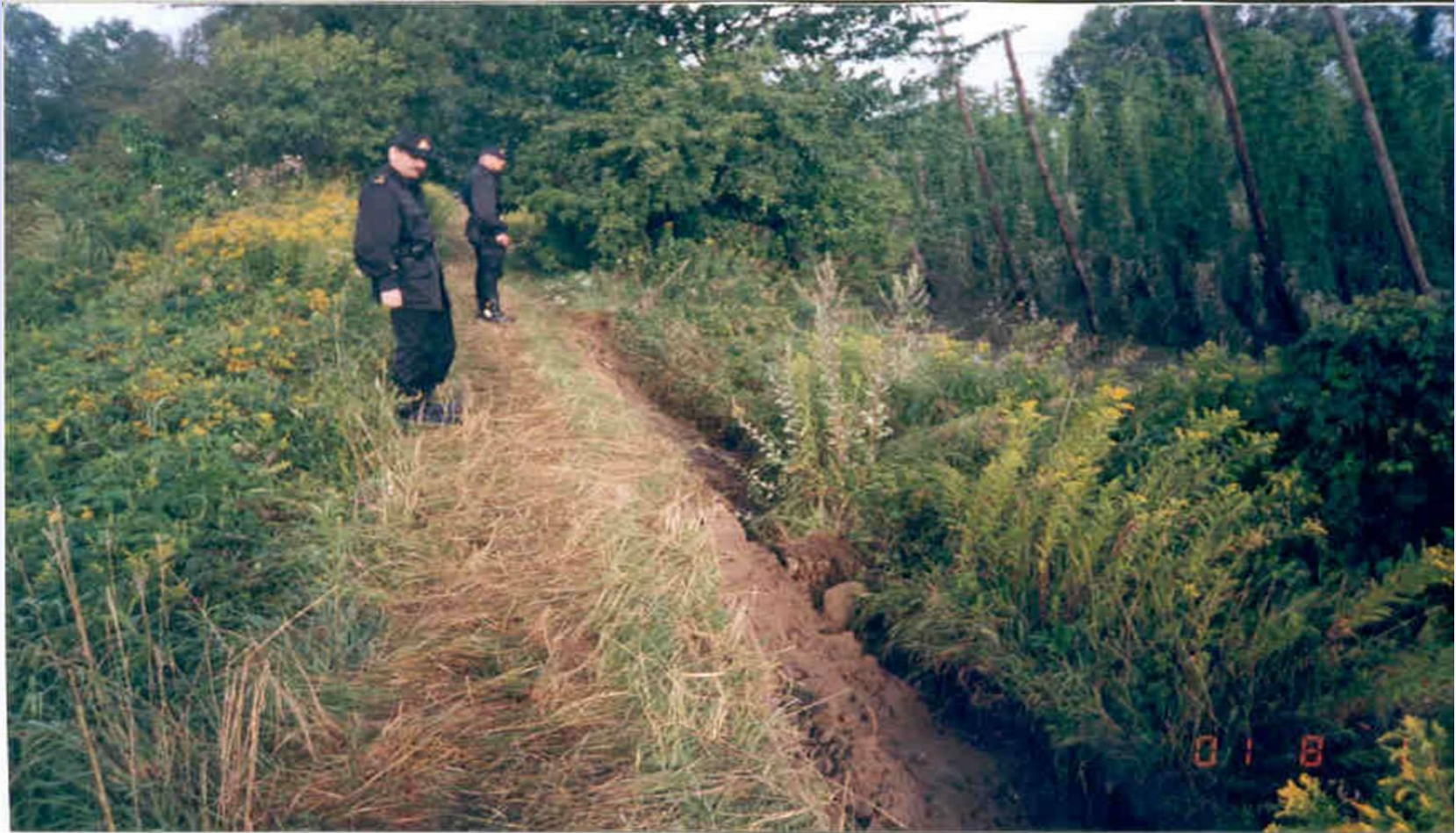
OSUNIĘCIE SKARPY WAŁU
