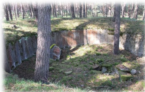
Fot. 109. Zbiornik przeciwpożarowy 200 m 3 — sektor D (fot. R. Rzeszuto)
