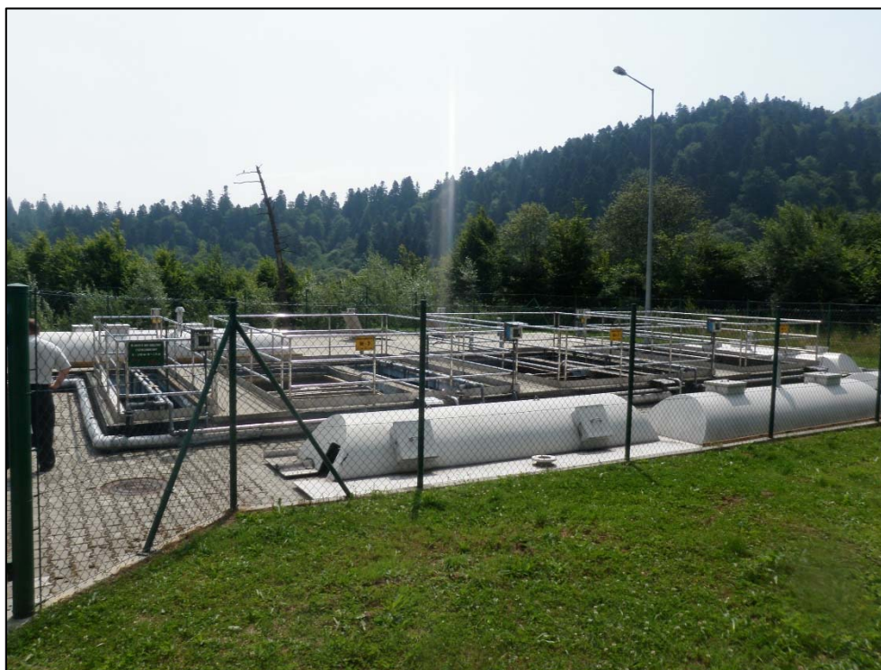
Ryc. 2. Ogólny widok na urządzenia gminnej oczyszczalni ścieków w Wołkowyji administrowanej przez Gminny Zakład Komunalny Sp. z o. o. w Polańczyku, Wołkowyja, 2015-07-09.
